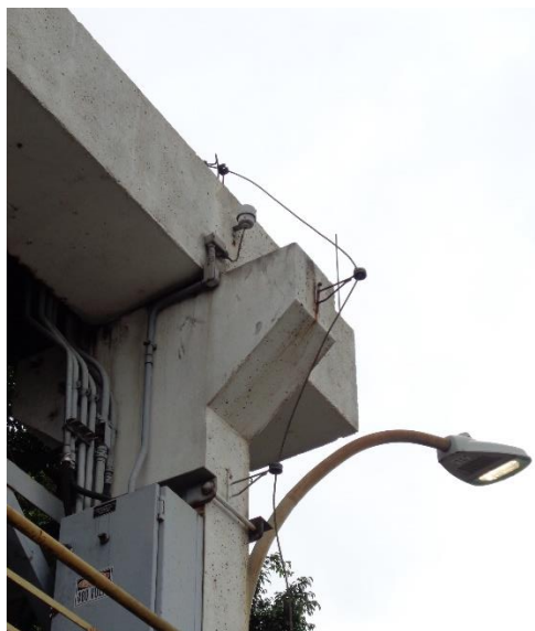
Figura 47 – Relé Fotocélula próximo ao condutor de descida
