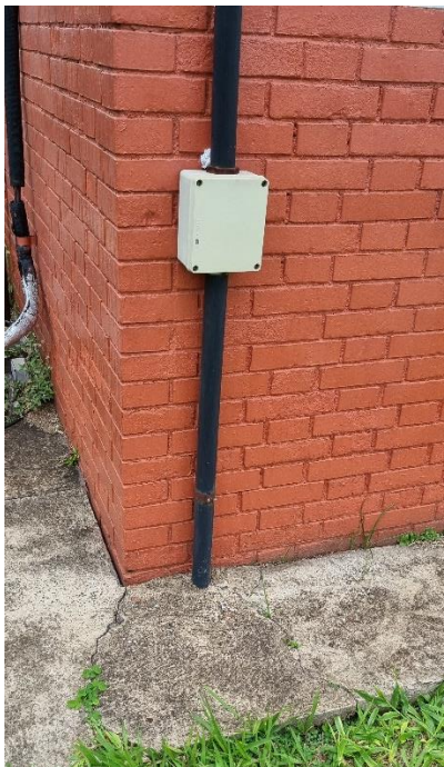
Figura 22 – Caixa de inspeção suspensa
