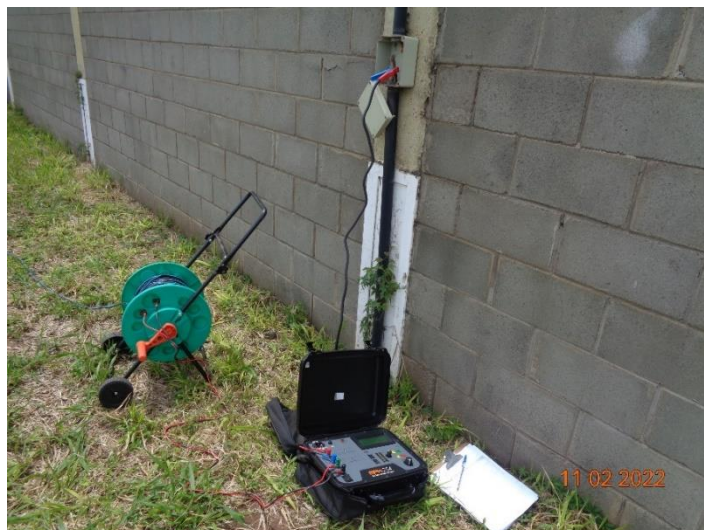
Figura 50 – Medição da Continuidade do Eletrodo de Aterramento
