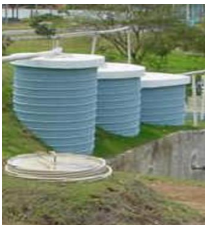
Figura 1- Sistema de biodigestores anaeróbios de fluxo ascendente implantado na UNESP Guaratinguetá.
