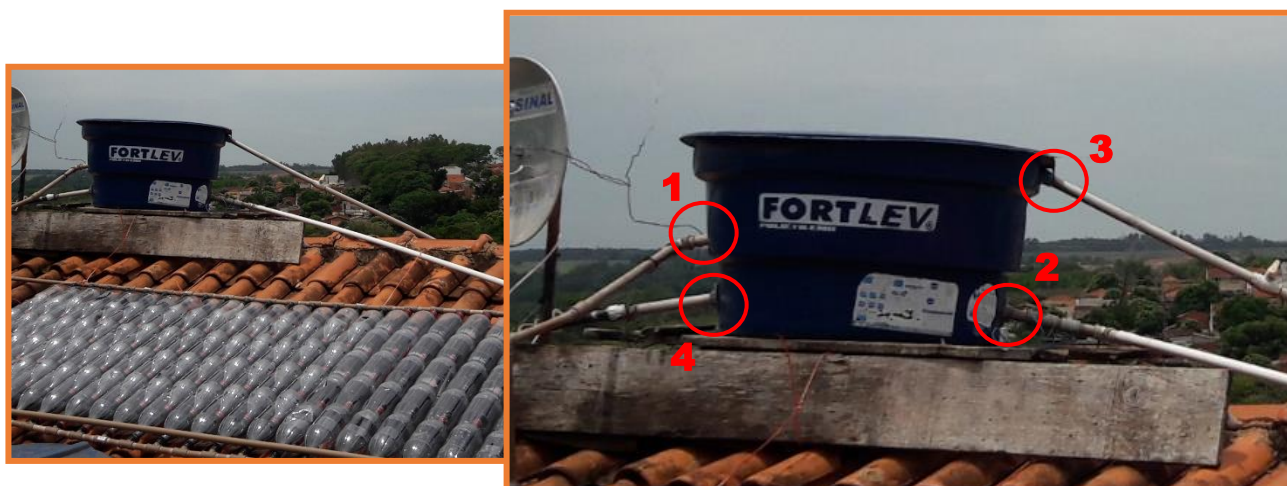
Figura 11 – Paine solar instalado/Próprio autor
