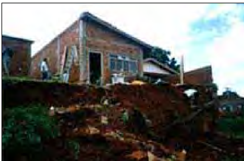
Foto 6: Muro de Arrimo Derrubado pela Enxurrada.
