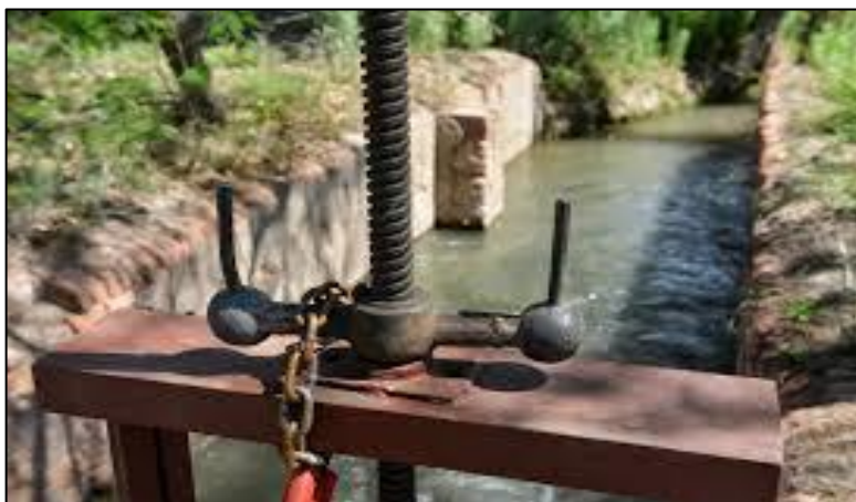
Ilustración 9 - Una acequia, compuerta de riego con candado y sin fin.
