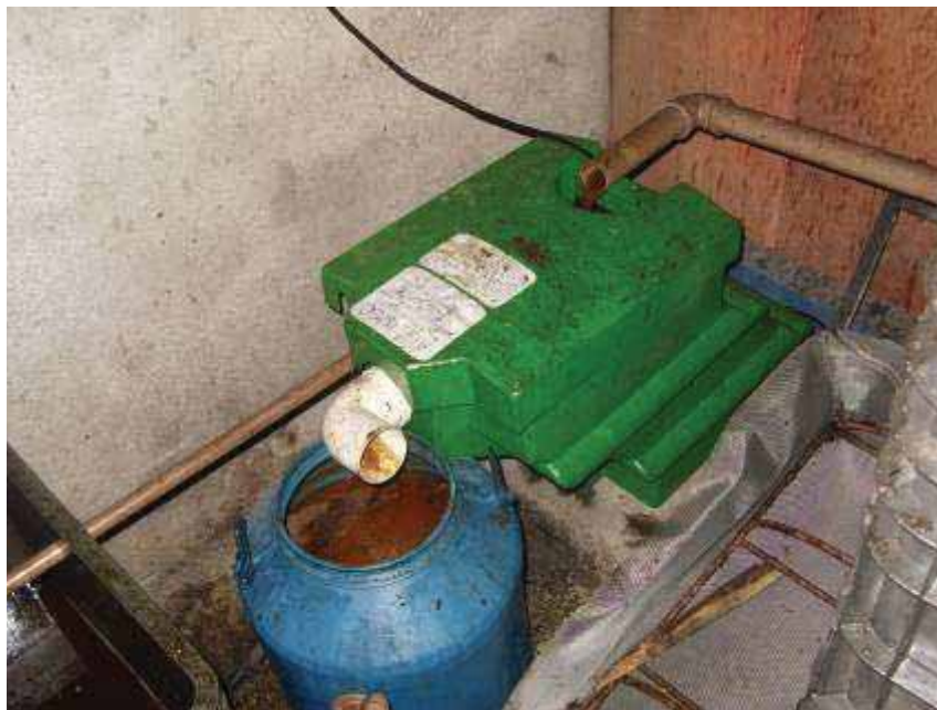
Foto 26 -. Desumidificador. (equipamento de cor verde). Crédito: R A Pafunda
