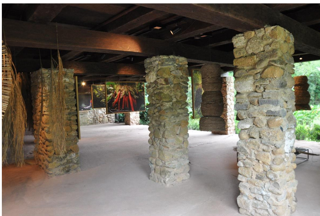
Figura 121 – Pavimento térreo do engenho da Faz. Bananal. Pilares sem paredes de vedação.
