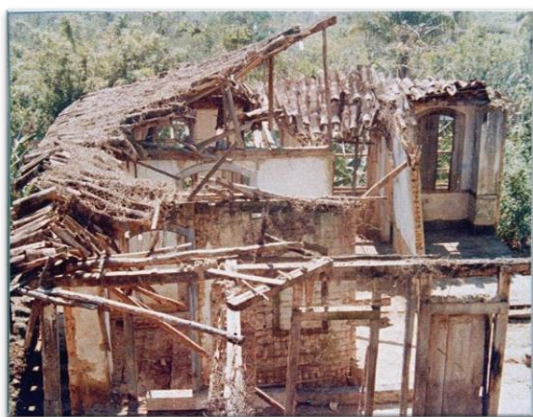
Figura 114 – Casa-grande do Engenho da Fazenda Olaria em ruínas.
