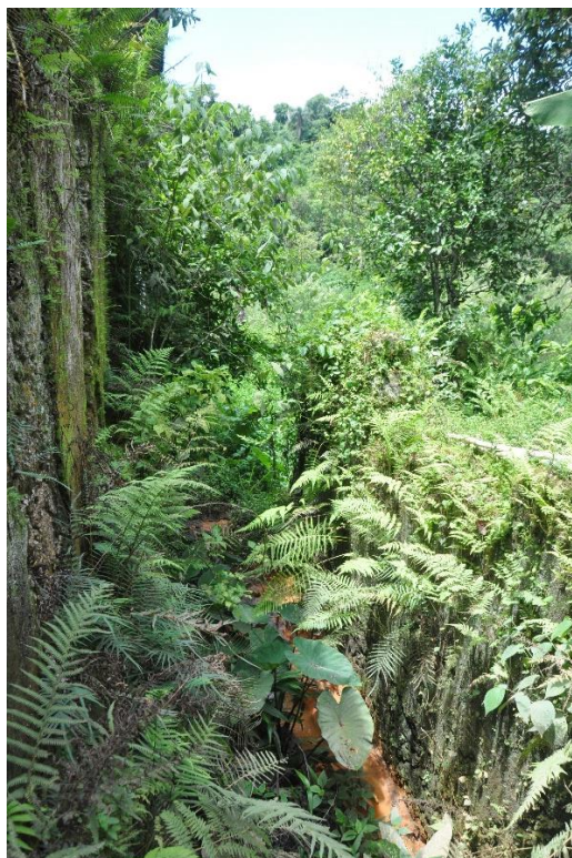
Figura 65 – Inferno da Roda do Engenho Bom Retiro, na fachada dos fundos do Casarão.
