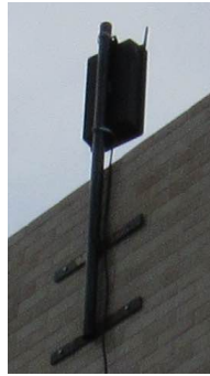
Figura 41 – Roteador ZigBee instalado no Campus 2 da UFCat.
