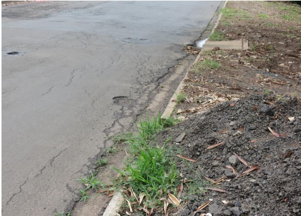
Figura 24: Rachaduras no asfalto decorrentes da erosão (Rua 22Jsp x Avenida 1)
