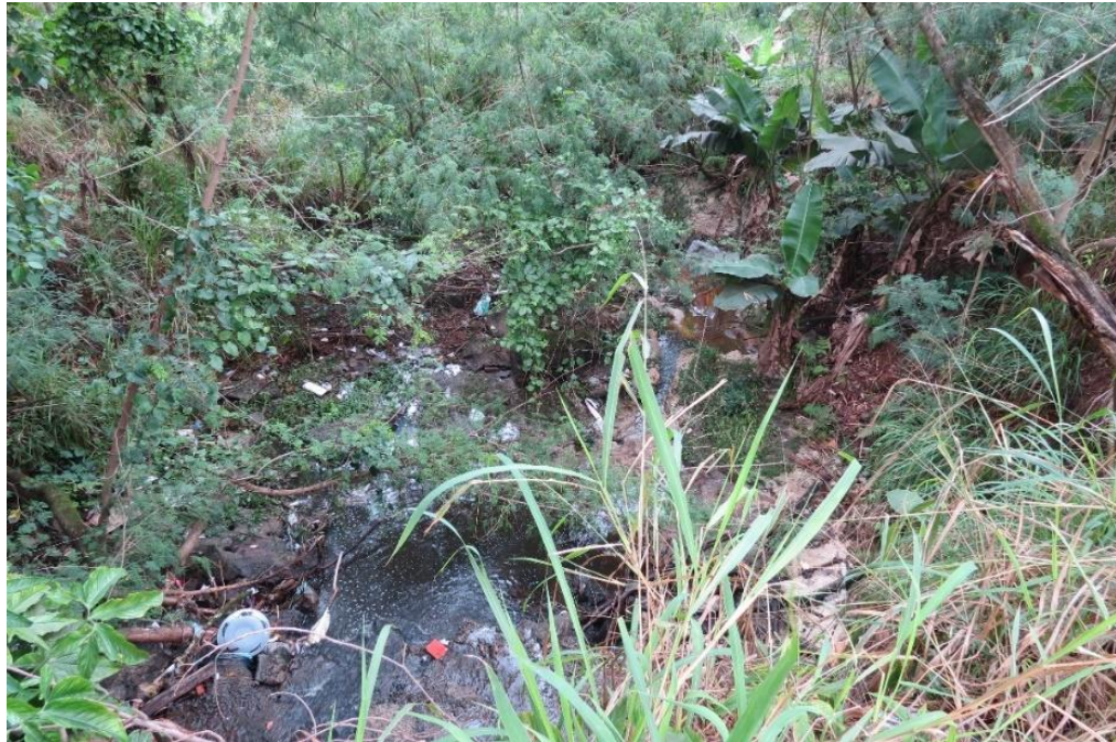
Figura 21: Dreno após a área de foco de inundação (Rua 22 Jsp em esquina com a Avenida 10)
