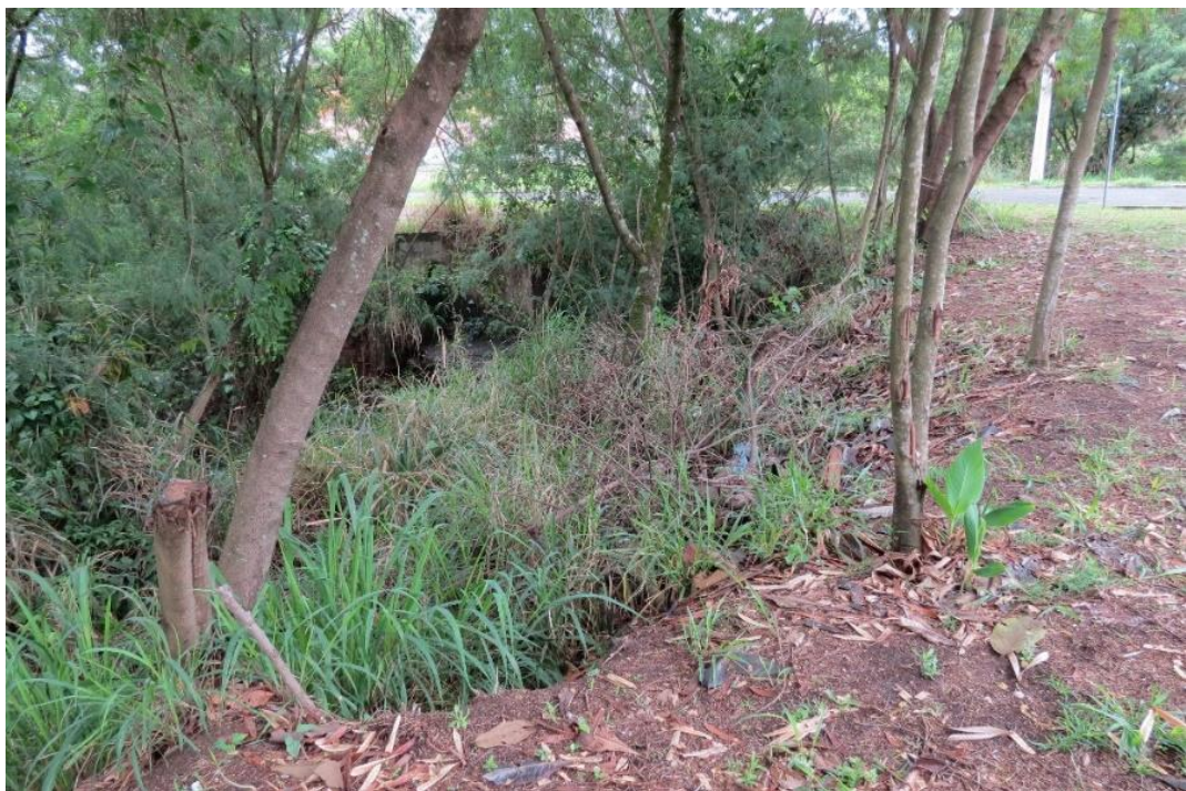
Figura 22: Erosão Marginal (Rua22 Jsp em esquina com a Avenida 10)
