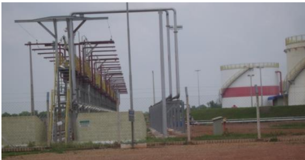
Fotografia 5 - Estrutura da empresa BUNGE para escoamento de etanol
