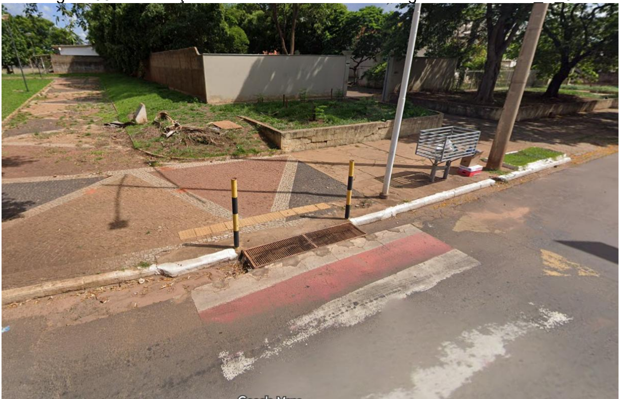
Figura 33 - Presença de Detritos em Trecho do Segmento da AVBN D 5.
