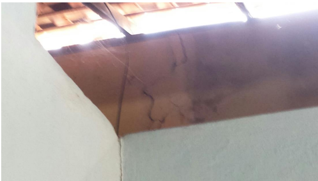
Figura 101: Vão entre a parede e o teto em domicílio localizado no bairro Primavera, zona norte de Teresina.
