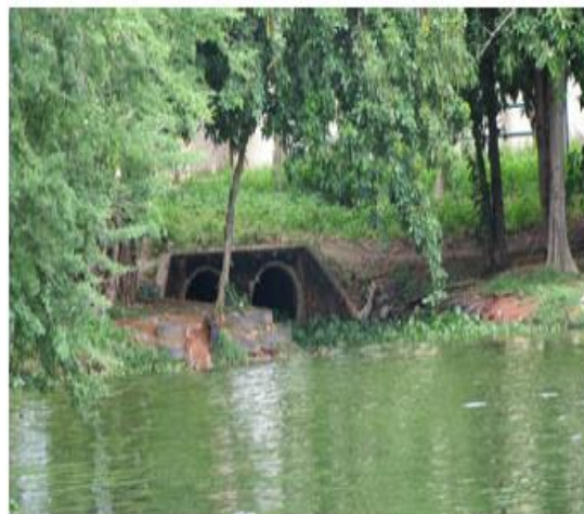
Figura 65: Efluentes líquidos sendo lançados sem tratamento na lagoa localizada no bairro Nova Brasília, zona norte de Teresina.
