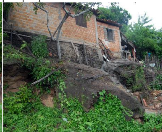
Figura 73: Casas construídas em terreno íngreme na rua Lions, bairro Satélite, zona leste de Teresina e sujeitas a deslizamentos durante precipitação intensa. .
