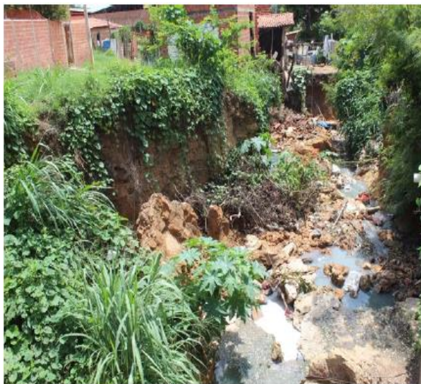
Figura 66: Erosão da galeria localizada no Parque Afonso Gil, zona sul de Teresina, após intensa precipitação.
