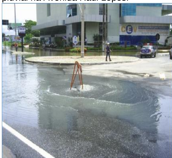
Figura 79: Refluxo de água da drenagem pluvial na Avenida Raul Lopes.
