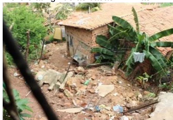
Figura 75: Terreno que desabou no bairro Parque Rodoviário, zona sul de Teresina, culminando com a queda do muro e atingindo as casas vizinhas.
