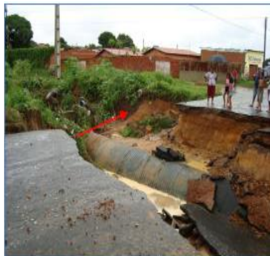
Figura 69: Bueiro rompido após intensa precipitação, localizado na rua Celso Pinheiro, bairro Três Andares, zona sul de Teresina.
