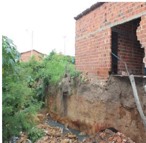
Figura 67: Casa que desabou com a intensa erosão da galeria localizada no Parque Afonso Gil, zona sul de Teresina, após intensa precipitação.
