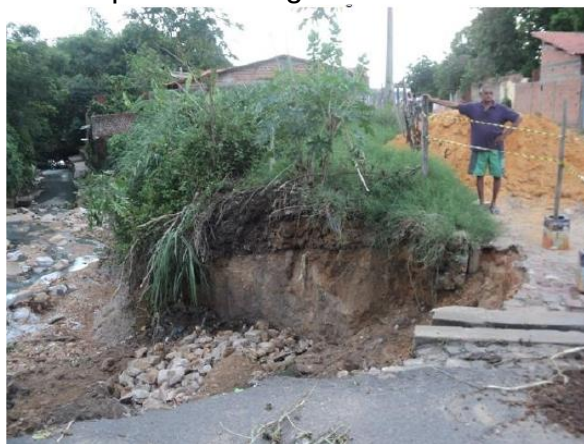
Figura 68: Erosão provocada pelo colapso da galeria localizada no bairro Comprida, zona sudeste de Teresina após um evento de precipitação intensa, que engoliu um poste, parte de ruas e quintais de algumas residências.
