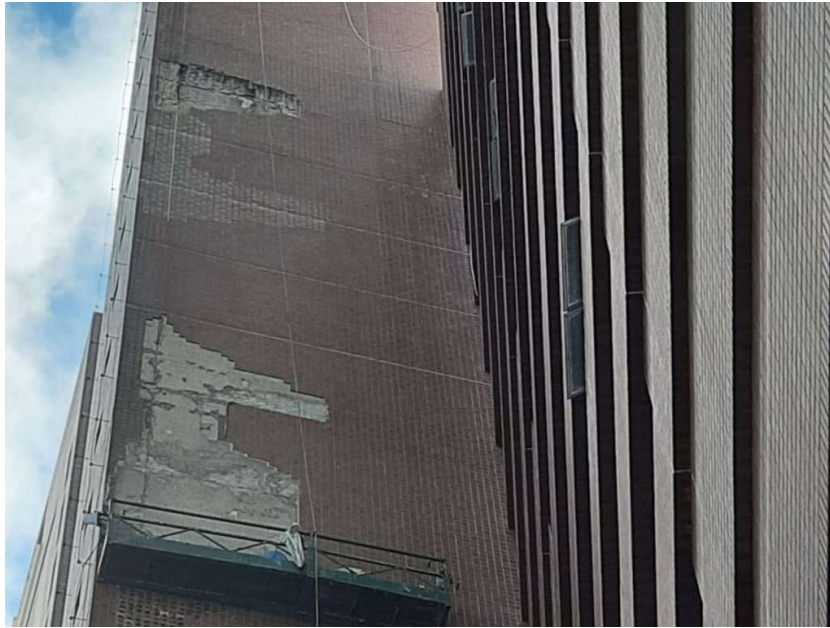
Figura 9 - Deslocamento de revestimento cerâmico em fachada
