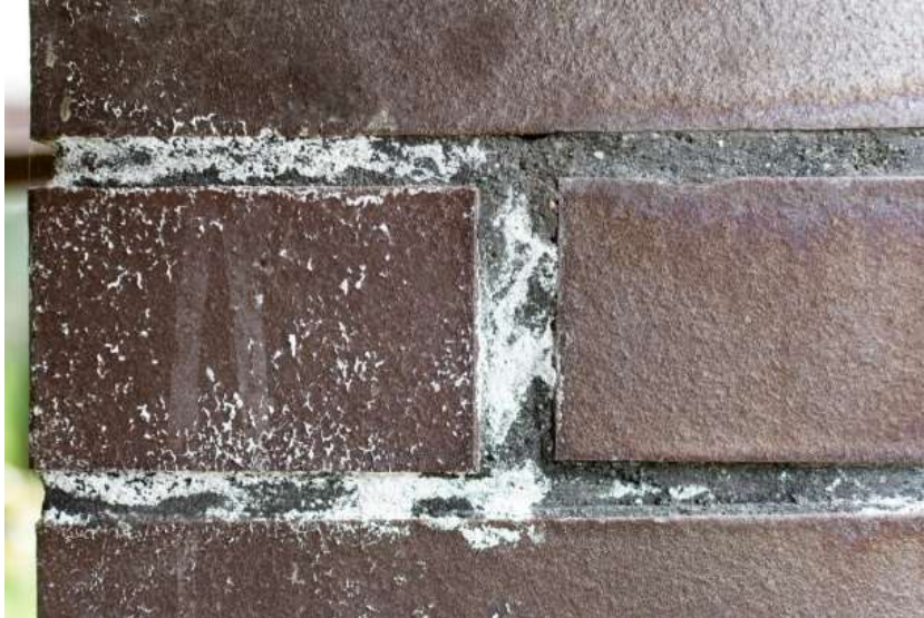
Figura 1 - Eflorescência em revestimento de fachada
