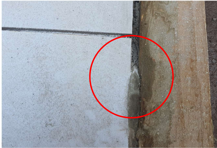
Figura 34 - Primeiros sinais de eflorescência no Protótipo 01
