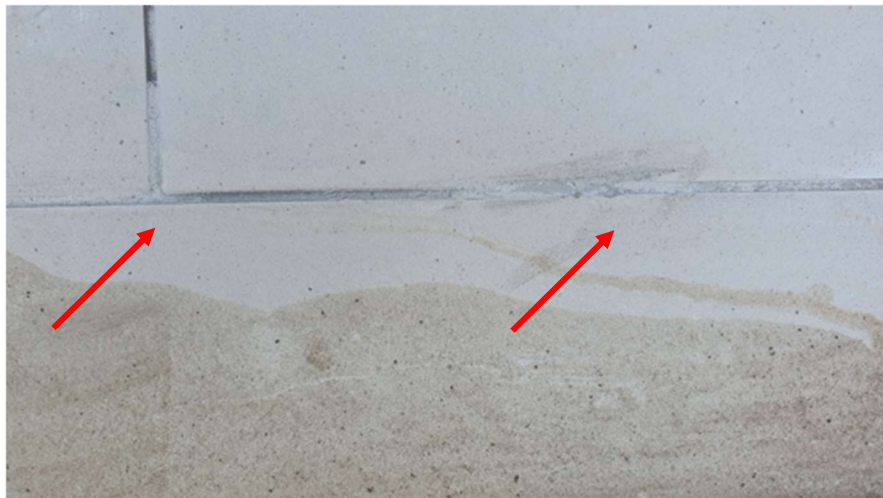
Figura 35 - Primeiros sinais de eflorescência no Protótipo 02
