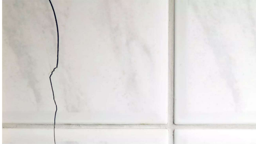
Figura 8 - Trinca em revestimento cerâmico
