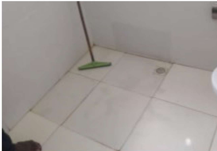
Figura 11 - Revestimentos cerâmicos com manchas d'água
