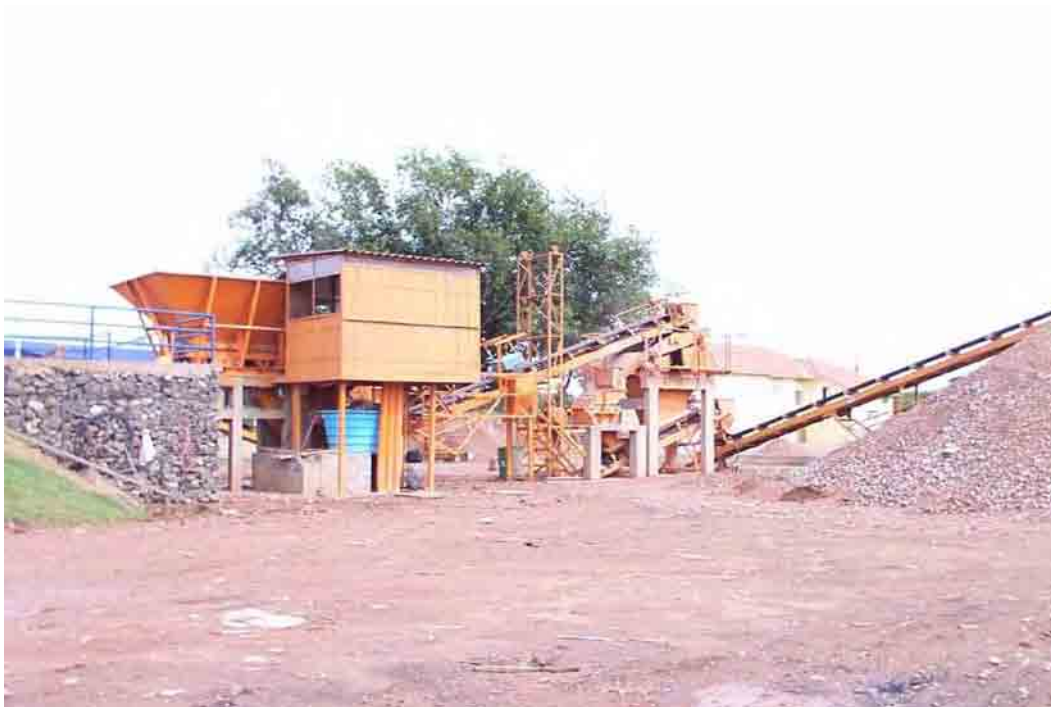
Foto 2.9 (out2003) – Usina de moagem de Piracicaba-SP, da esquerda para a direita, plataforma de abastecimento, alimentador vibratório, sala de operação, britador de mandíbula (abaixo da sala de operação), transportadores de correias fixos e móveis e rebritador de impacto.
