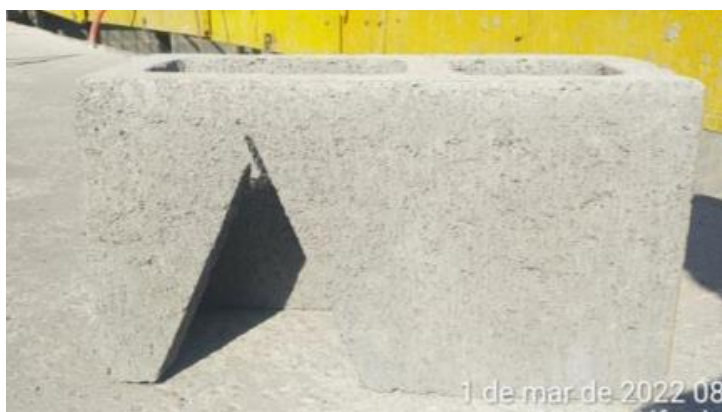
Figura 22 – Janela de inspeção
