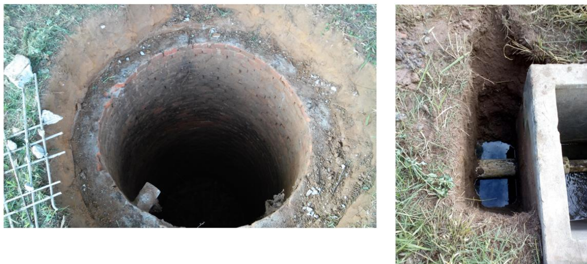
Figura 2. Prováveis fontes de contaminação do Aquífero Rio Claro por nitrato: a) Fossas sépticas; b) Vazamentos pontuais de rede de esgoto, linhas de esgoto.
