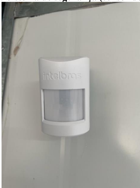
Figura 24: Sistema de segurança (sensor de presença)
