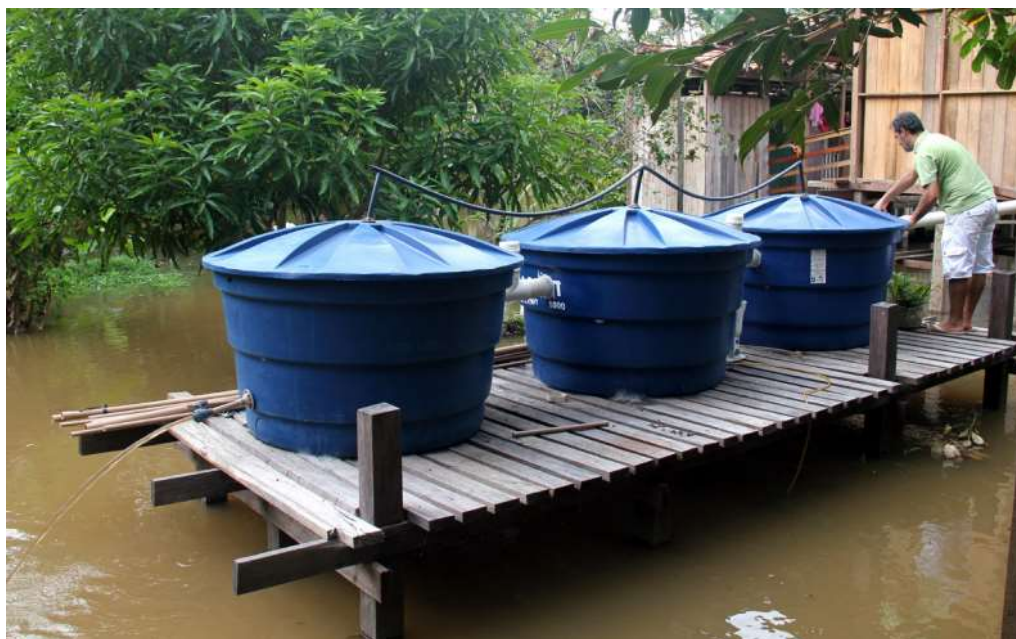
Figura 9 – Fossa biodigestora adaptada para várzeas
