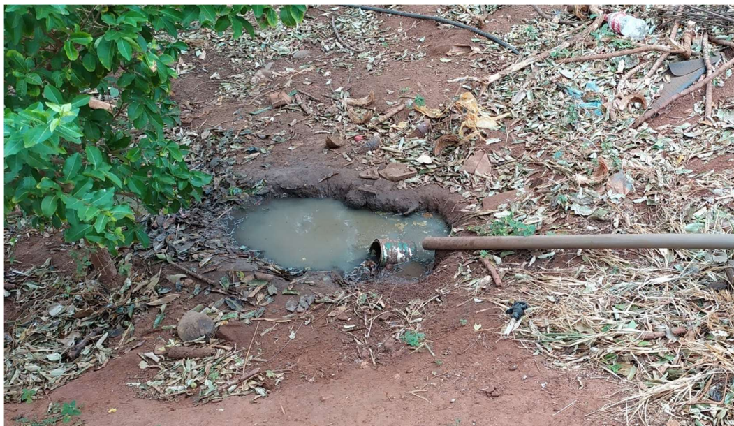
Figura 16 – Lançamento de águas cinzas a céu aberto
