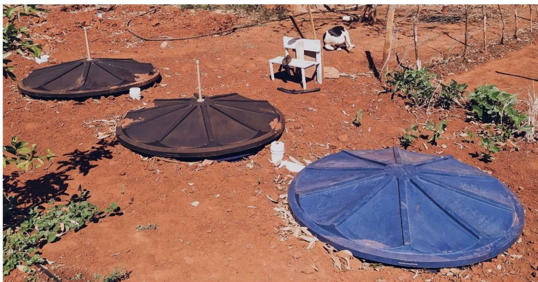
Figura 22 – Fossa biodigestora em funcionamento
