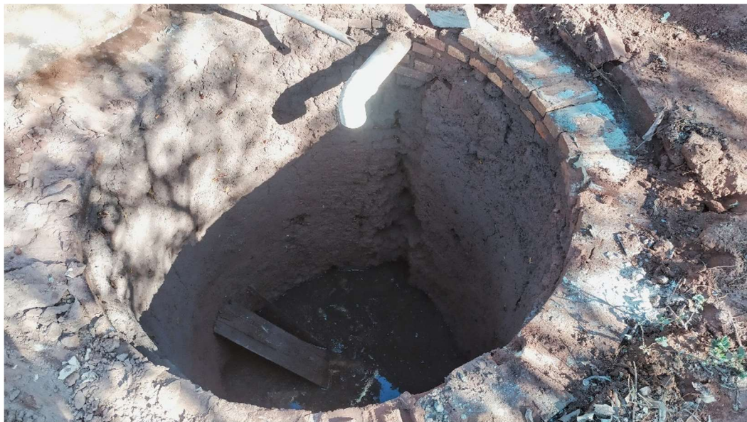
Figura 15 – Lançamento de esgoto em fossa rudimentar
