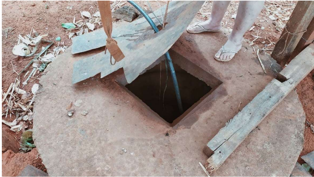
Figura 14 – Captação de água em poço raso
