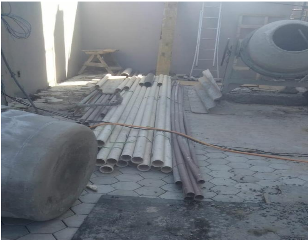
Figura 17 – Tubos sem identificações
