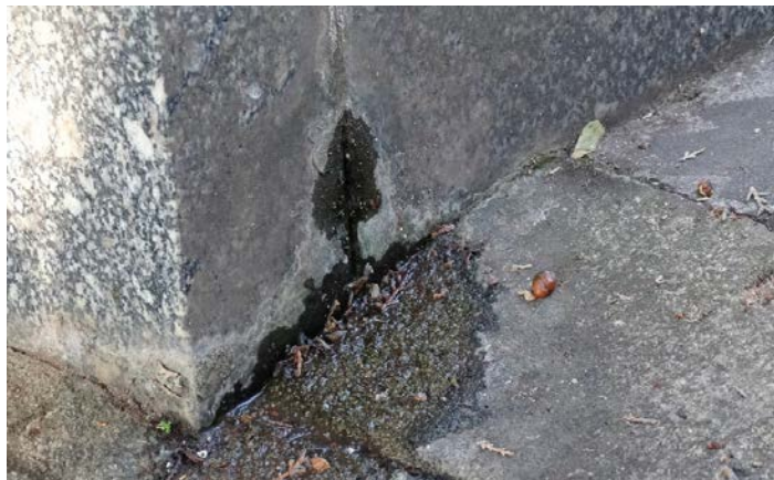
Figura 7: Extravasamento de necrochorume no cemitério municipal de Rio Claro, registrado em 2016. Os sepultamentos contínuos no cemitério atuam como fontes recorrentes de contaminação. Acervo pessoal.
