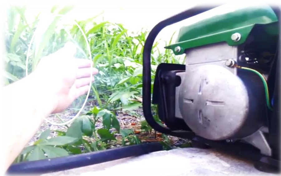
Figura 26 - Motogerador soltando fumaça, palma da mão com névoa branca
