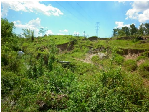
Foto 52. Seção E1 com margem erodida causada pela penetração do gado no canal. Foto do autor.
