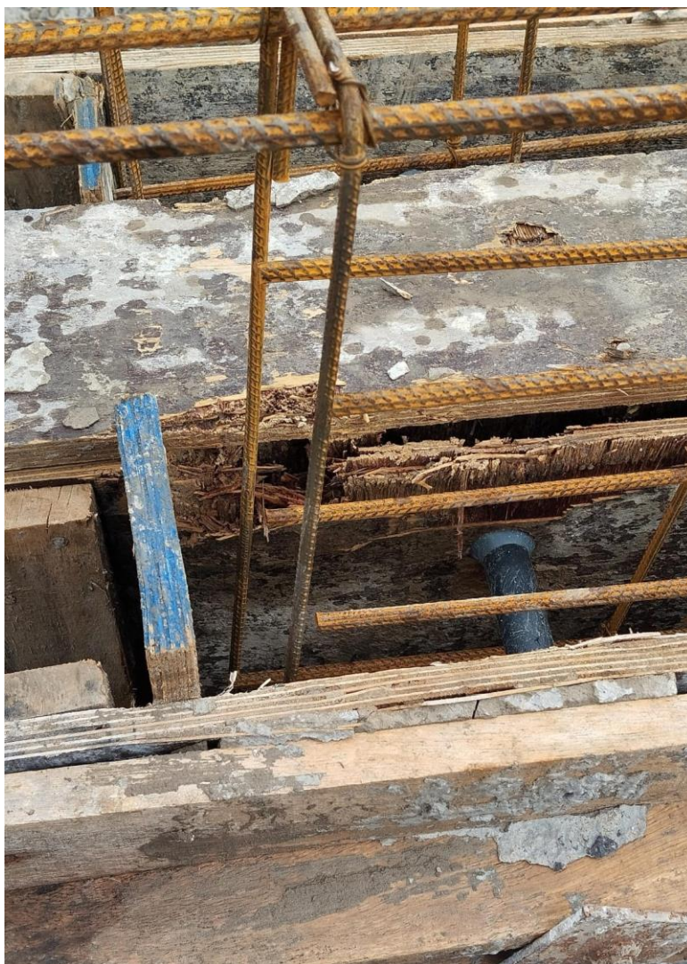
Figura 9 - Foto de uma fôrma de viga pré-moldada sem as intervenções corretivas.
