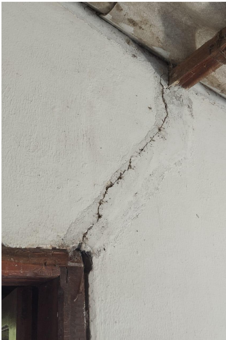
Figura 13 - Foto de uma trinca diagonal na parte superior de uma porta.
