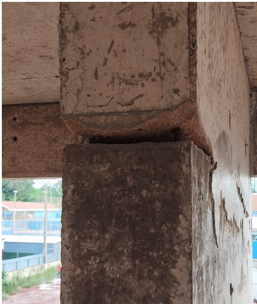
Figura 11 - Foto de armadura exposta numa junta de concretagem.
