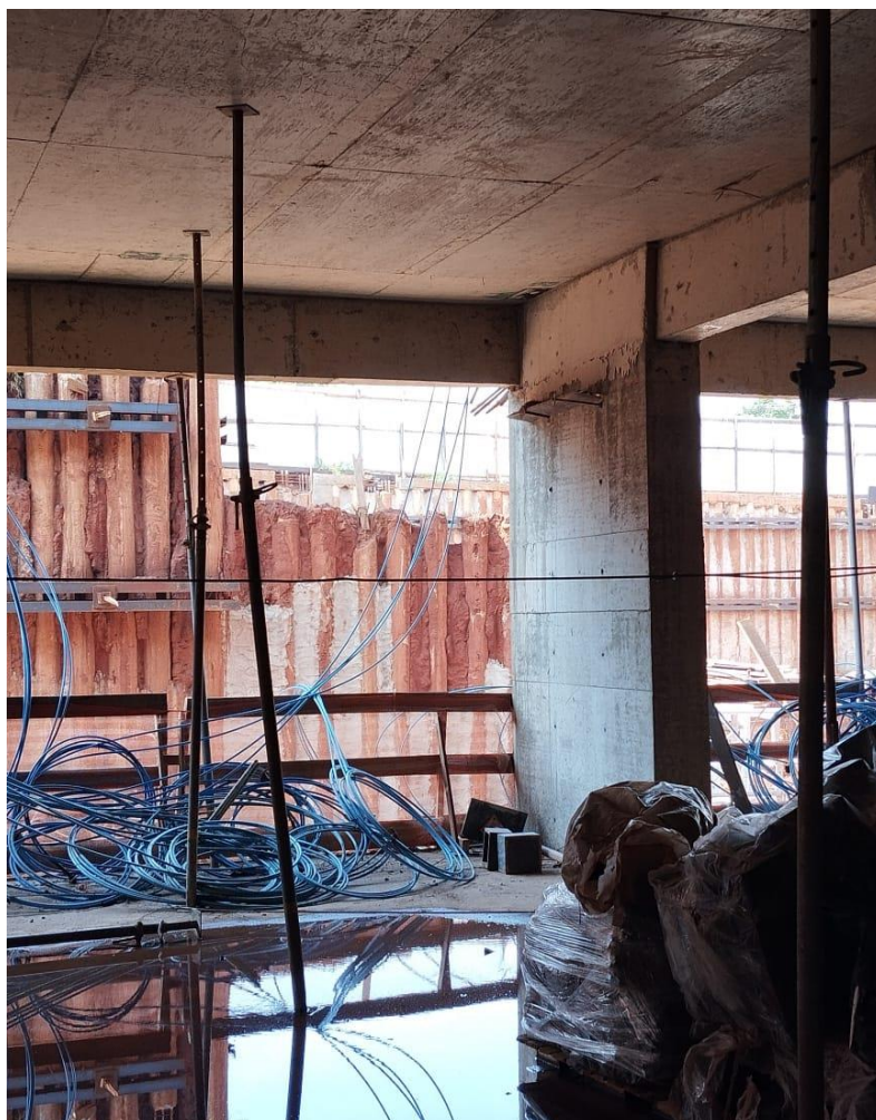
Figura 17 - Foto de escoramentos exemplificando a flambagem em laje.
