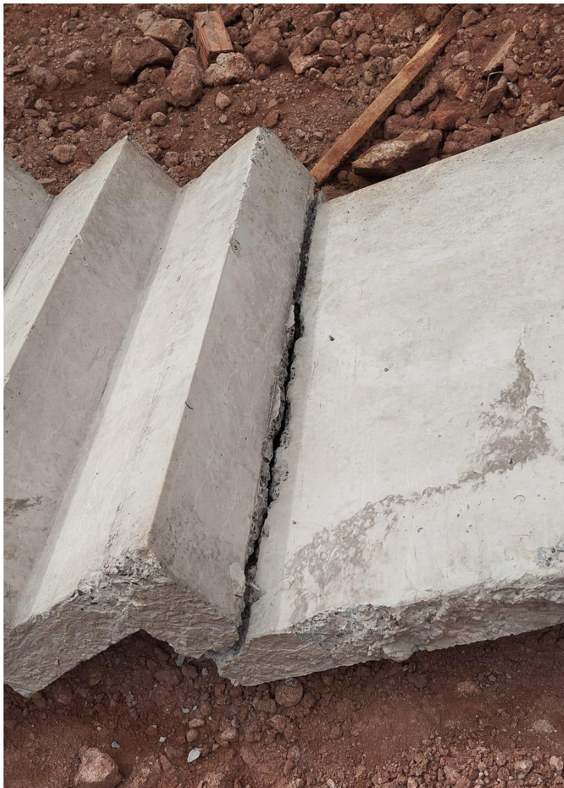
Figura 14 - Foto de uma rachadura numa escada pré-moldada.
