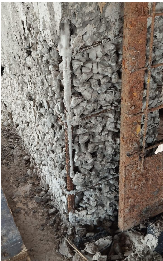
Figura 8 - Foto da base de um pilar mostrando um exemplo de segregação.
