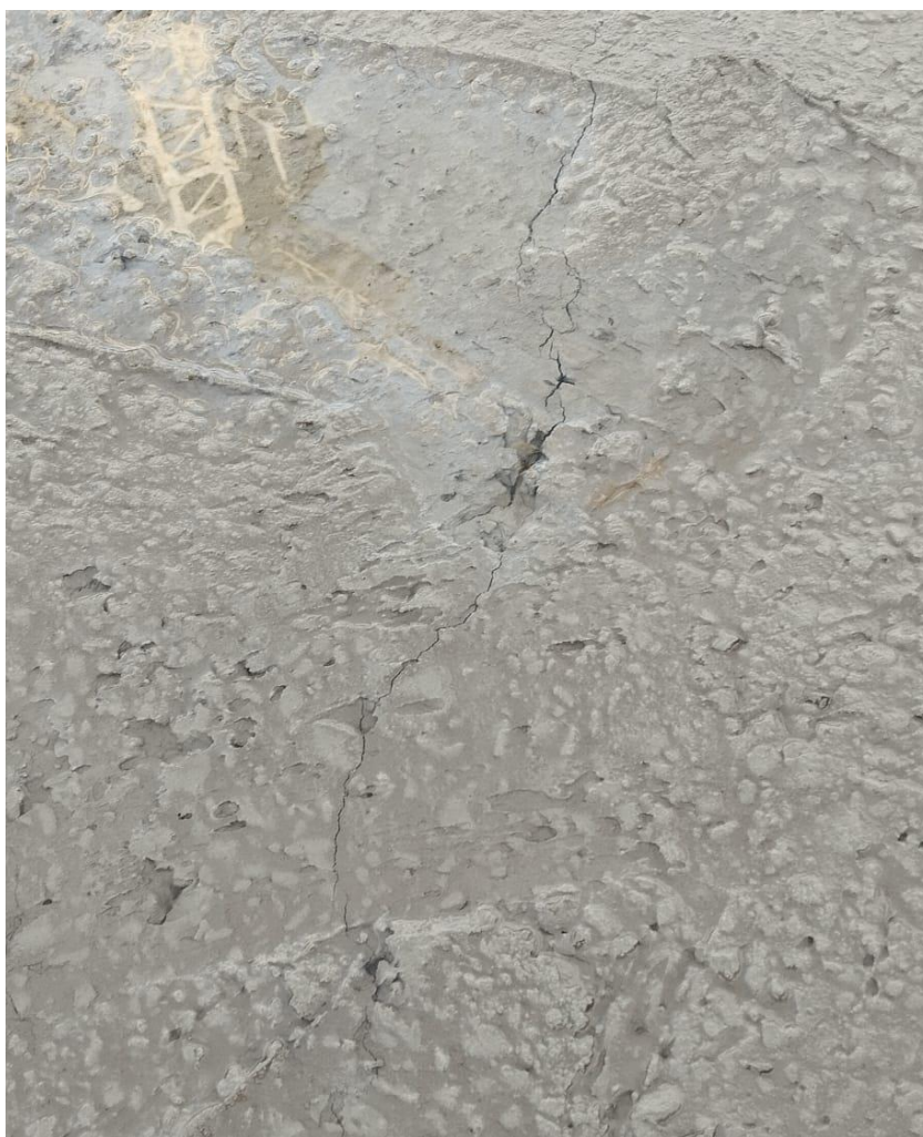
Figura 12 - Foto de uma fissura em laje recém concretada.
