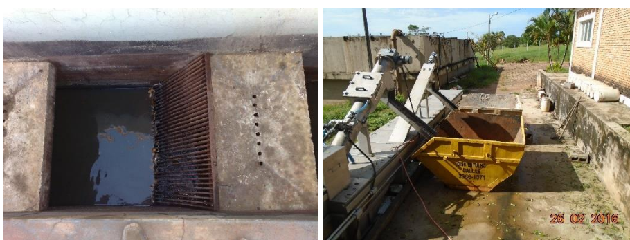
Figura 27 a e b – Vista superior de grade e sistema de gradeamento mecanizado. Fonte: próprio autor.
