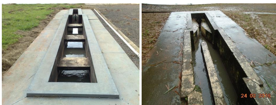
Figura 48 a e b – Desarenador Fonte: próprio autor.
