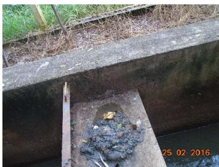
Figura 37 – Sistema de drenagem dos resíduos retidos no gradeamento. Fonte: próprio autor.
