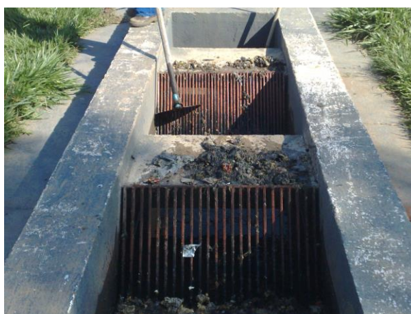
Figura 53 – Operador executando limpeza do gradeamento. Fonte: próprio autor.
