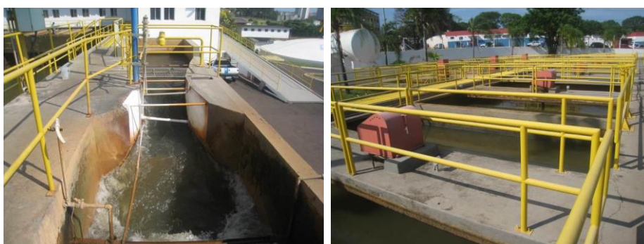
Figura 18 a e b – Entrada de água bruta, medidor ultrassônico de vazão e floculador hidráulico.
