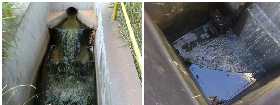
Figura 36 a e b – Sistema escada para aeração e lançamento final do esgoto tratado. Fonte: próprio autor.
