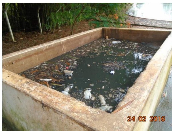
Figura 54 – Caixa de acumulação de resíduos gradeados e areia. Fonte: próprio autor.
