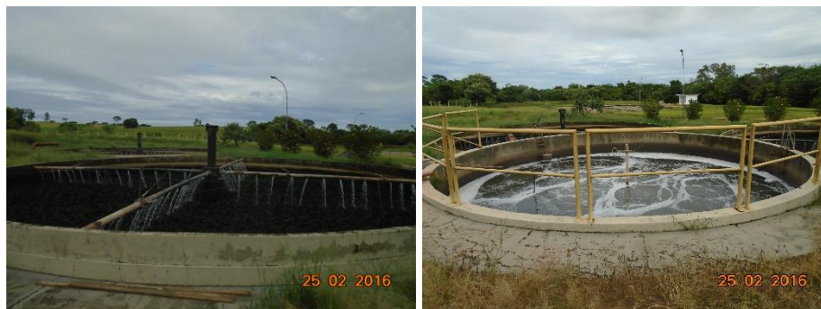
Figura 33 a e b – Filtro biológico e tanque de aeração. Fonte: próprio autor.
