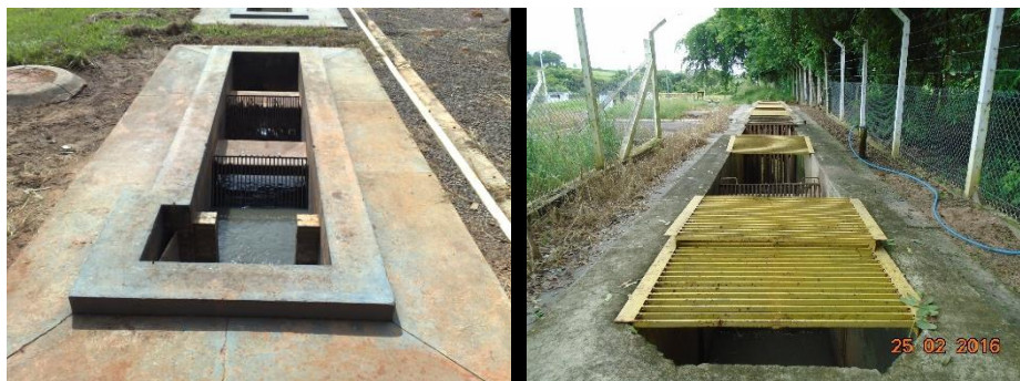
Figura 26 a e b – Sistema de gradeamento não mecanizado Fonte: próprio autor.
