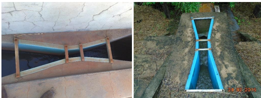
Figura 28 a e b – Exemplos de Calha Parshall instalados para controle de vazão. Fonte: próprio autor.
