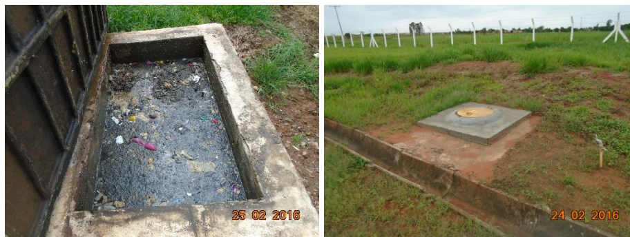
Figura 38 a e b – Caixas secas para acumulação de resíduos retirados do gradeamento. Fonte: próprio autor.
