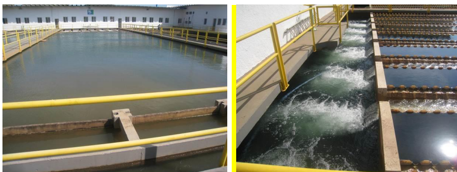
Figura 19 a e b – Decantador e filtro de areia.
