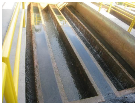
Figura 20 – Detalhe do filtro de areia.
