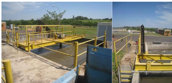
Figura 43 a e b – Sistema desarenador automatizado.
