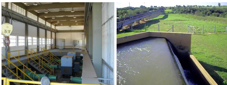
Figura 17 a e b – Casa de máquinas das Estações Elevatórias de Água Bruta. Fonte: Presidente Prudente (2009).
