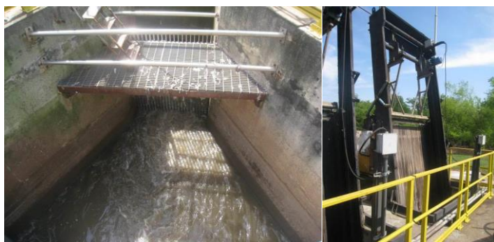
Figura 42 a e b – Sistema de gradeamento ETE Limoeiro. Fonte: próprio autor.
