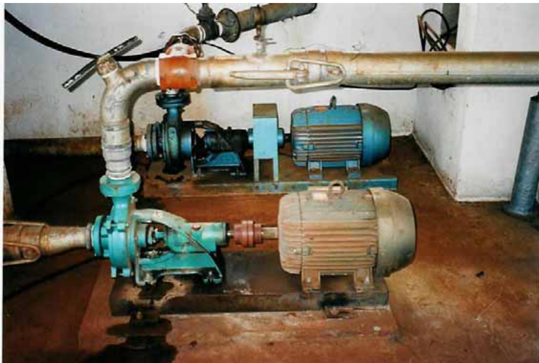
FIGURA 4. Bomba d'água com motor de indução trifásico de 25 CV acoplado.
