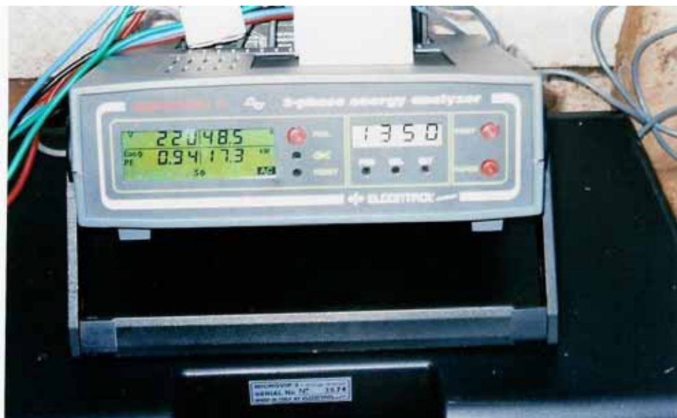
FIGURA 5. Medidor de energia.
