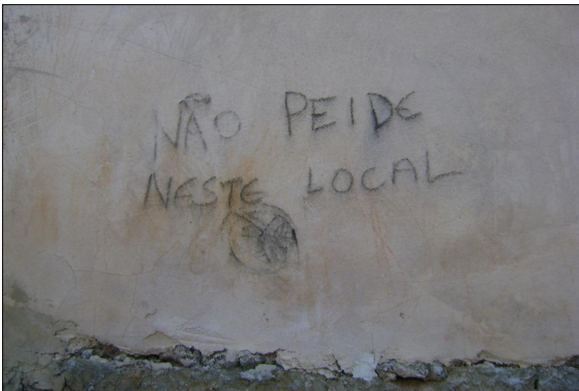
Foto 45: Muros internos pichados no Condomínio Tecumseh Village, em São Carlos. Fonte: Viviane F. de Oliveira/Trabalho de campo/Maio de 2013.
