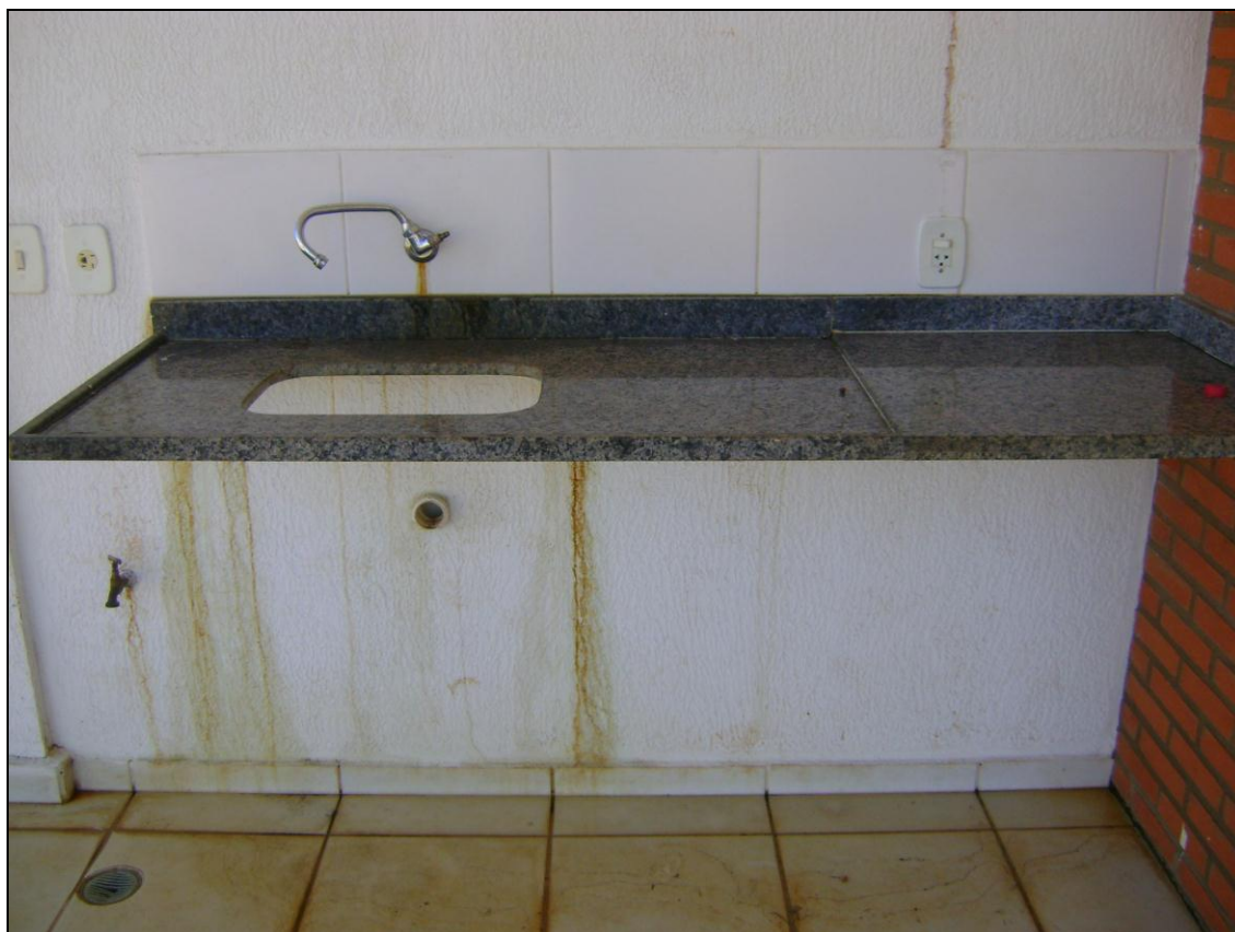
Foto 42: Detalhe para pia, cuba e cifão quebrados no quiosque do Condomínio Terra Nova São Carlos, São Carlos.
