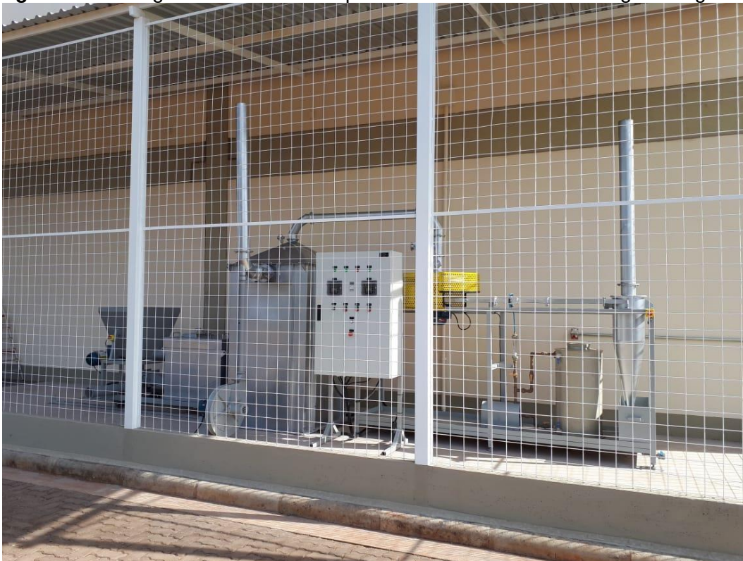
Figura 15. Vista geral do sistema de queimador de biomassa e lavagem de gases.
