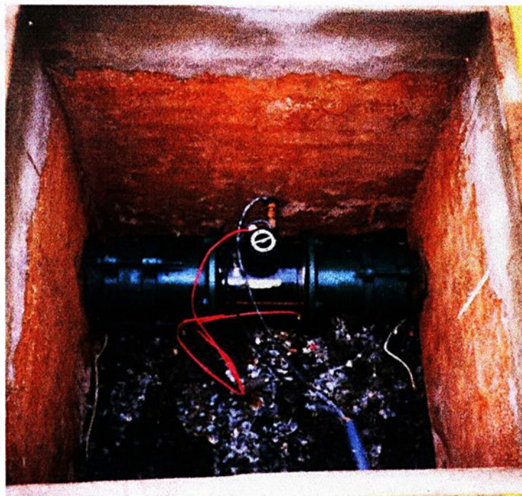
FIGURA 5.6 - Instalação do sensor eletromagnético de vazão.
