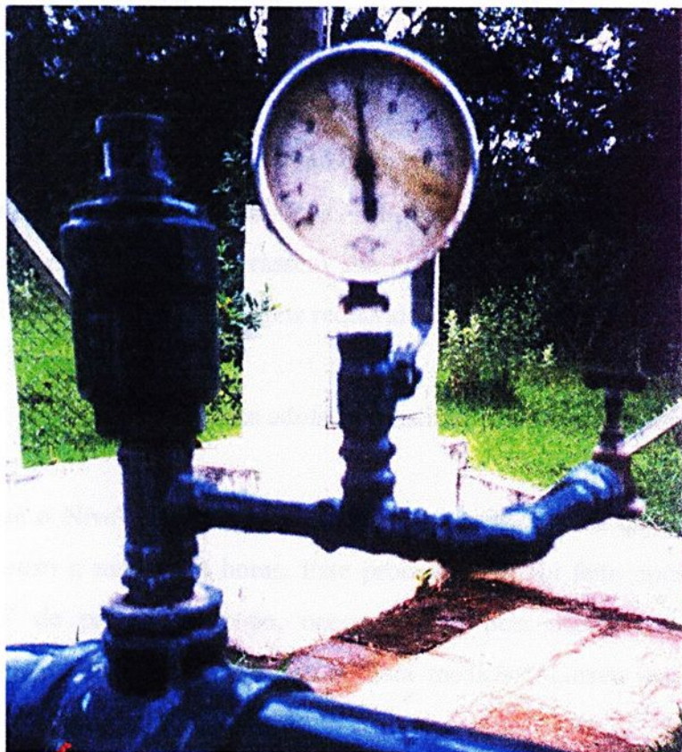
FIGURA 5.7 - Manômetro utilizado para medição da pressão na saída do poço.
