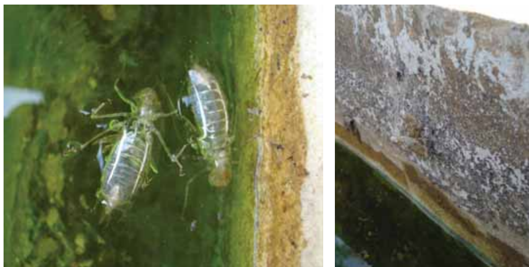
Figura 47: Exoesqueletos de insetos sobre a água e na parede do tanque de filtração ecológica.
