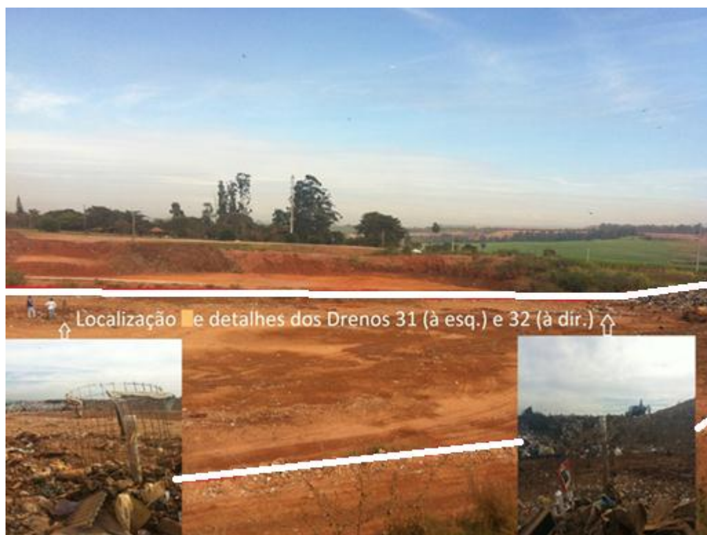
Figura 21: Vista lateral da nova célula de disposição de resíduos e detalhes (vistas frontais) dos drenos 31 e 32, selecionados para instalação dos conjuntos. Fonte: Autor.
