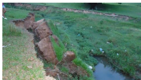
Solapamento no Córrego Sete de Setembro.
