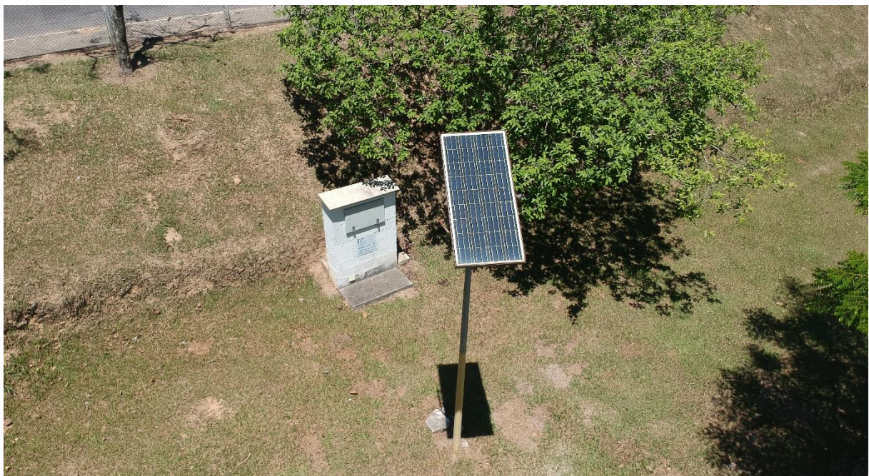
Figura 50 – Estrutura de geração Off-Grid “Ponto Iluminado”.
