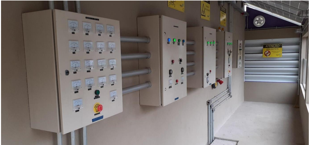
Figura 30 – Interior da central de geração.
