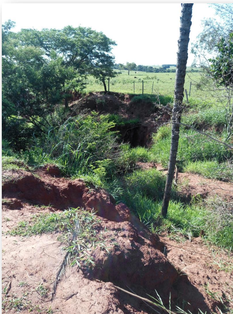
Figura 53 - Voçoroca próximo ao encontro entre um copo hídrico e estrada rural. Localização: lat. 20 22 4.1752; long. 50 53 43.2925
