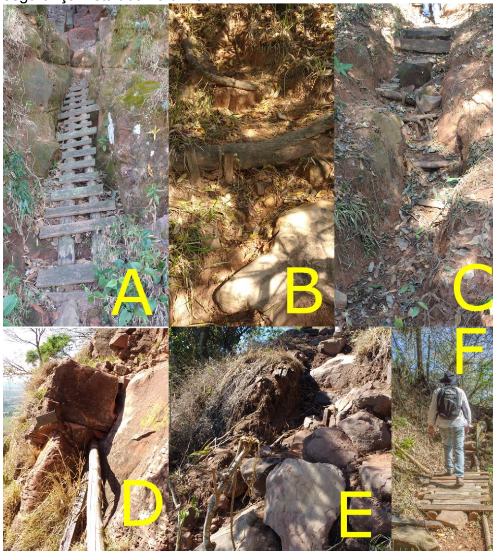
Figura 21 – Infraestrutura presente no local: A. Escada em boas condições; B. e C. barragens em condições precárias para sustentar a trilha; D. Acesso perigoso de um setor a outro do Morro; E. Blocos soltos na trilha; F. Ponte em boas condições de segurança instalada na trilha
