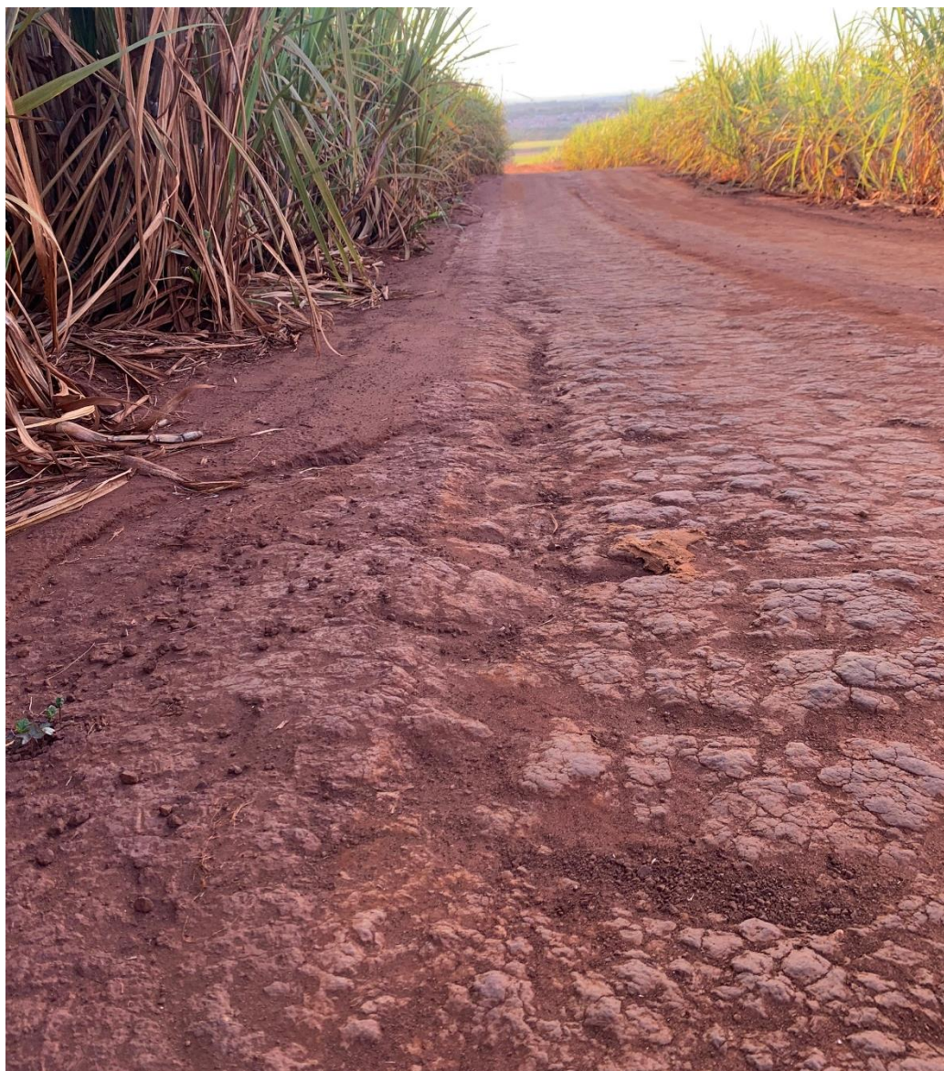
Figura 8 - Erosão em plataforma de estrada de terra.
