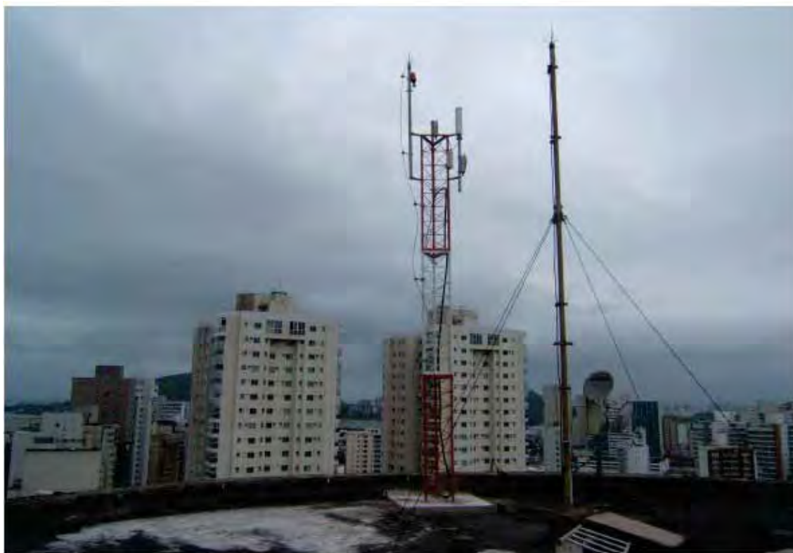
Figura 42 - Rádio Instalado com torre (Mtel, 2011)
