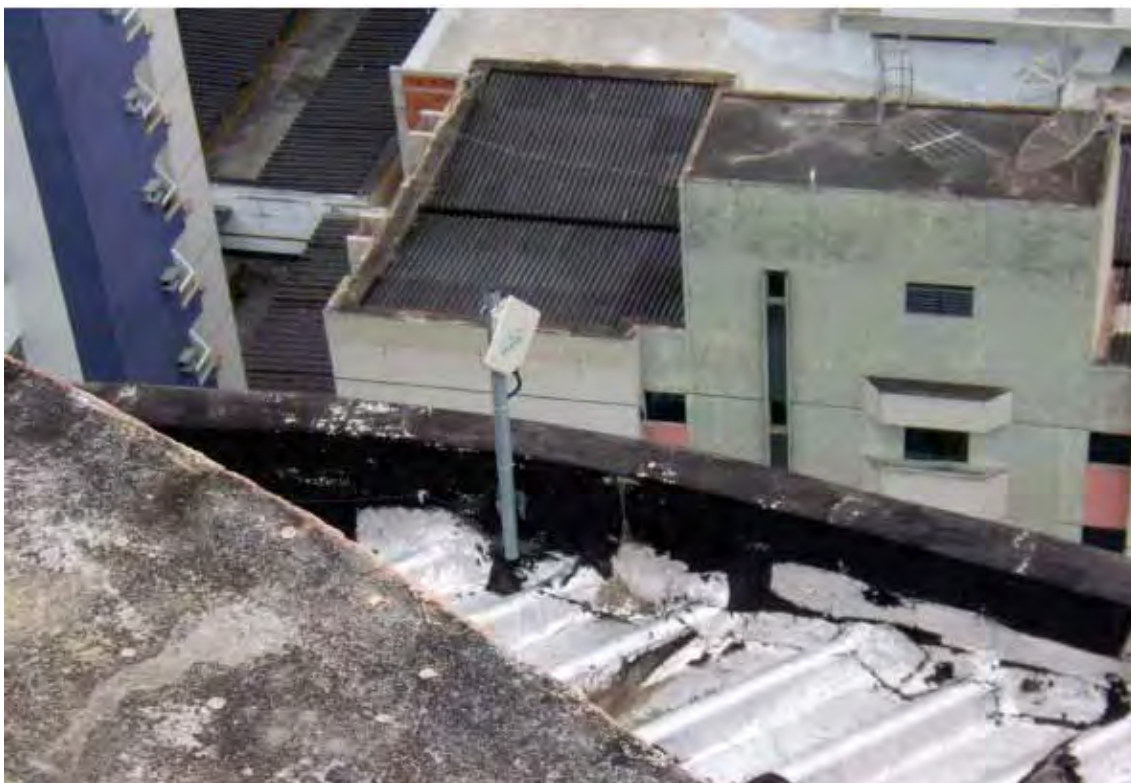
Figura 46 - Antena instalada no cliente (Mtel, 2011)
