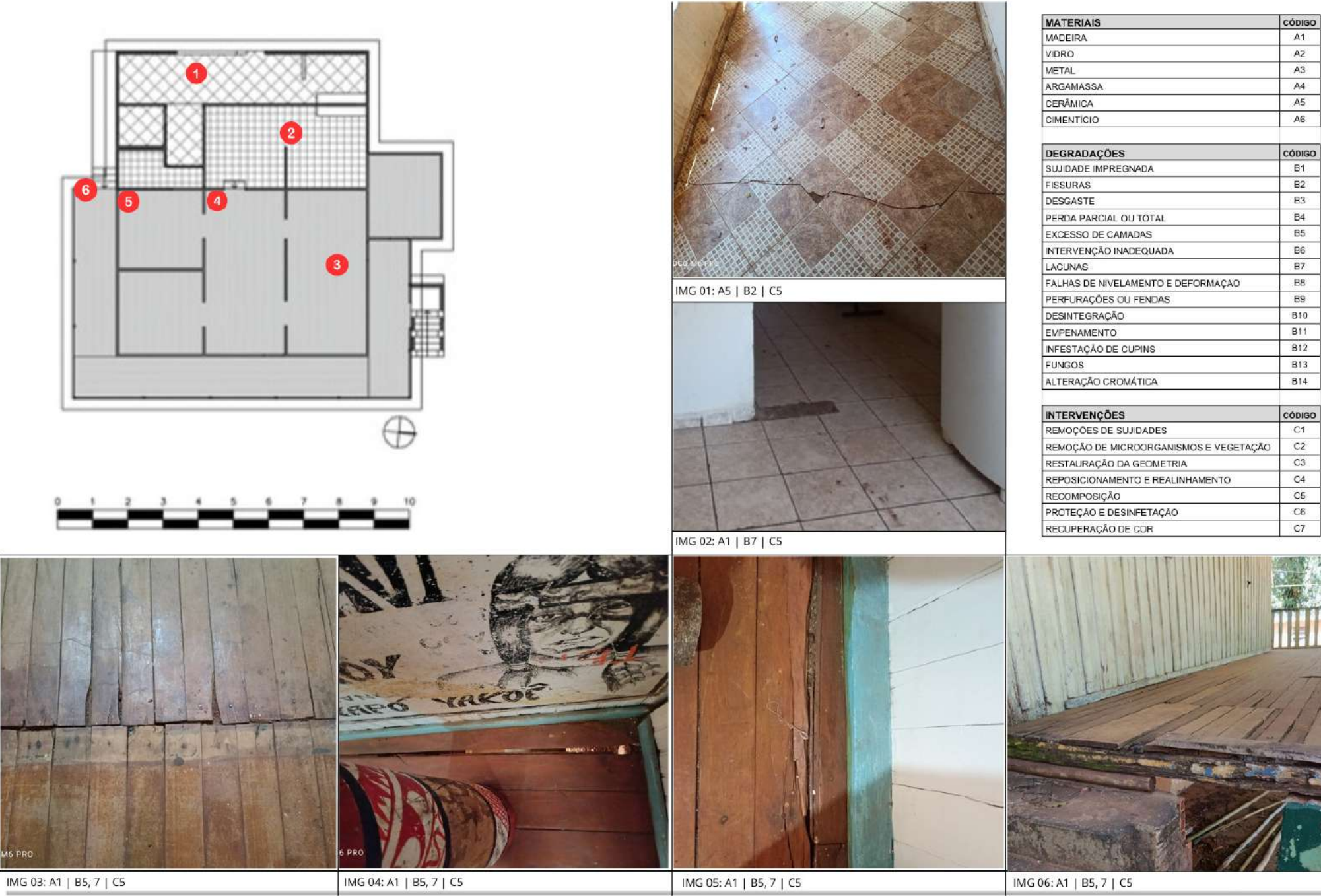
Figura 64_ Levantamento de patologias - pisos internos. Fonte: Autora, 2025.
