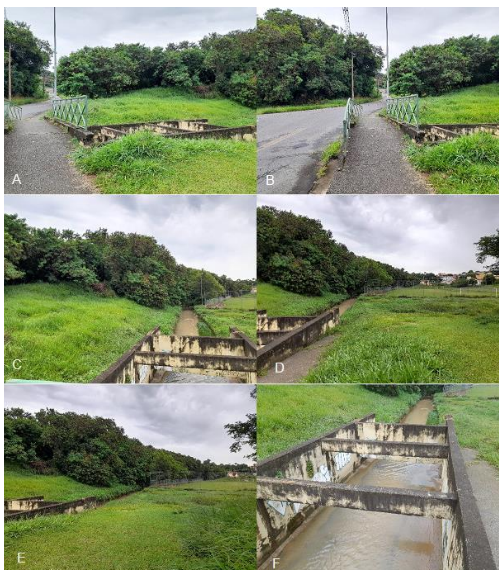
Figura 32 – Trecho T1 – elementos de impacto e degradação
