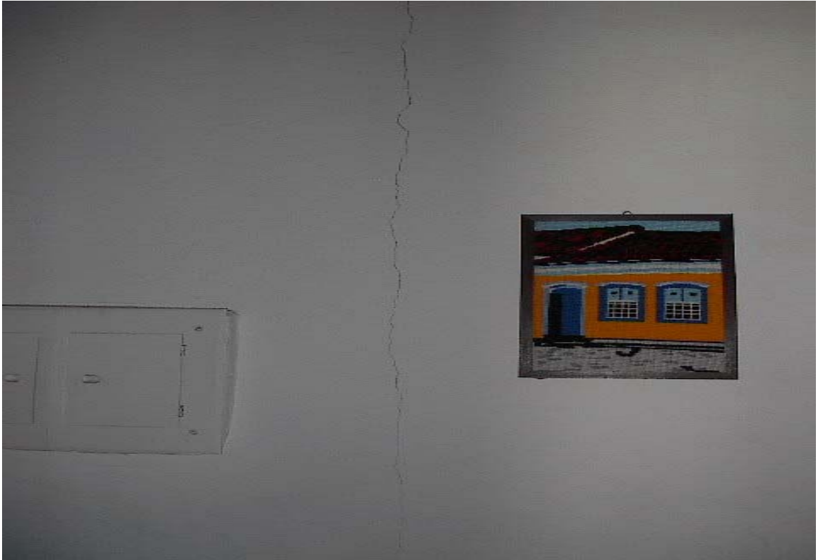
Foto VII – Edificação Tipo 5: Trincas na parede da sala.
