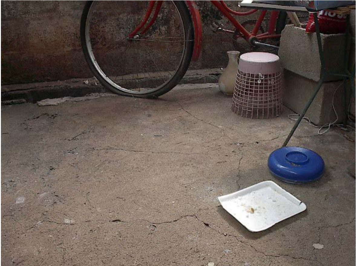
Foto V – Edificação Tipo 3: Trincas no piso do quintal, próximo à canaleta.
