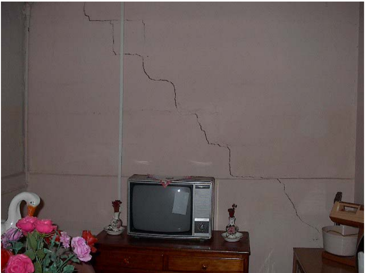
Foto IV – Edificação Tipo 3: Trincas na parede da cozinha, ao lado do banheiro.
