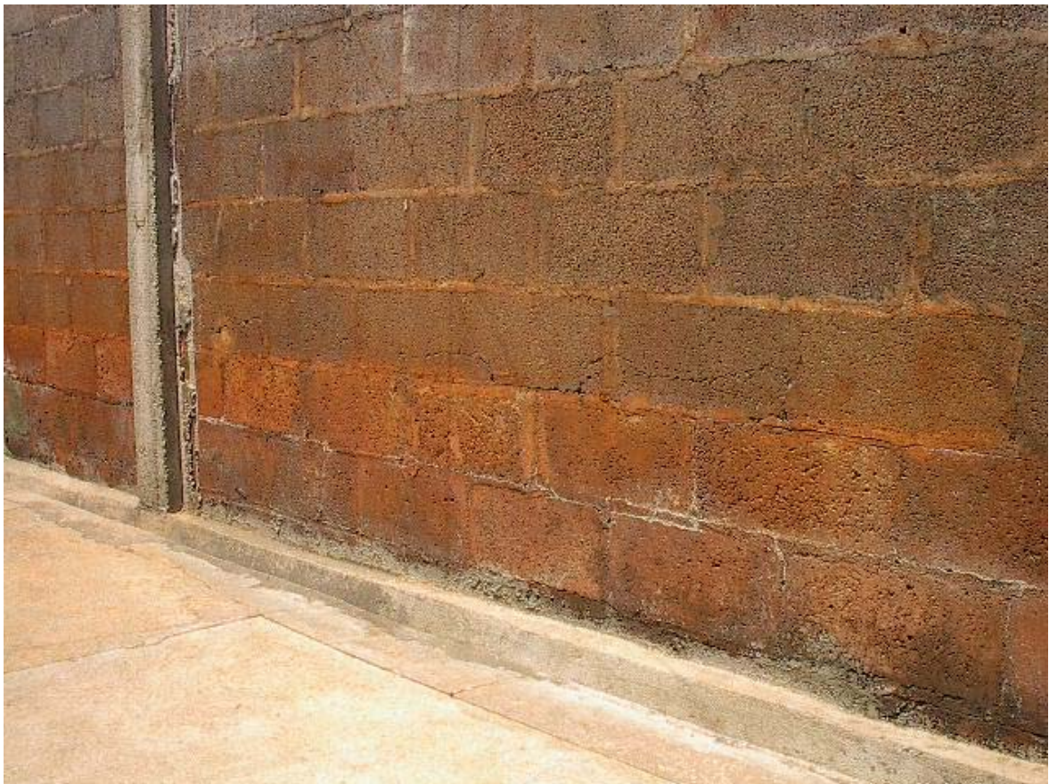
Foto VI – Edificação Tipo 4: Trincas no muro do quintal, próximo à canaleta.
