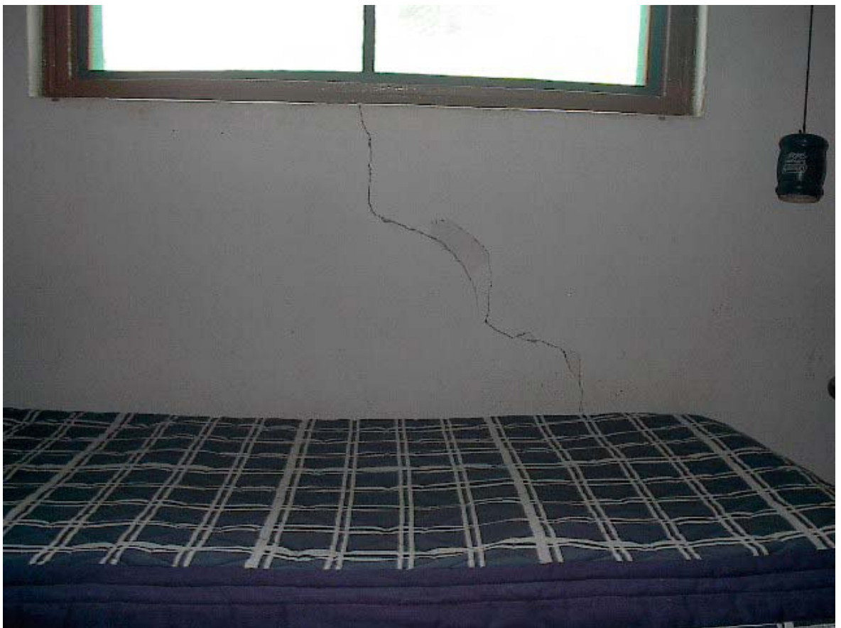
Foto VIII – Edificação Tipo 6: Trincas na parede do quarto.
