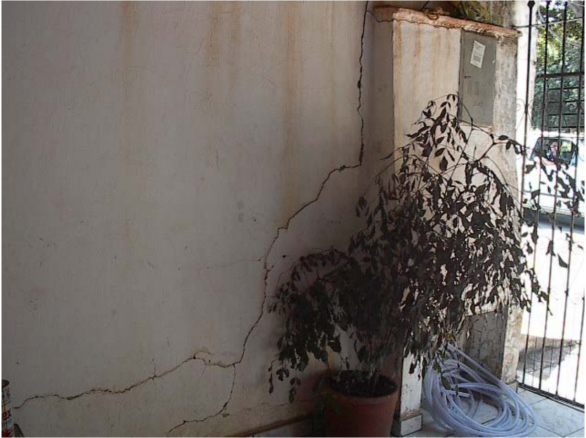
Foto III – Edificação Tipo 3: Trincas no muro da frente.
