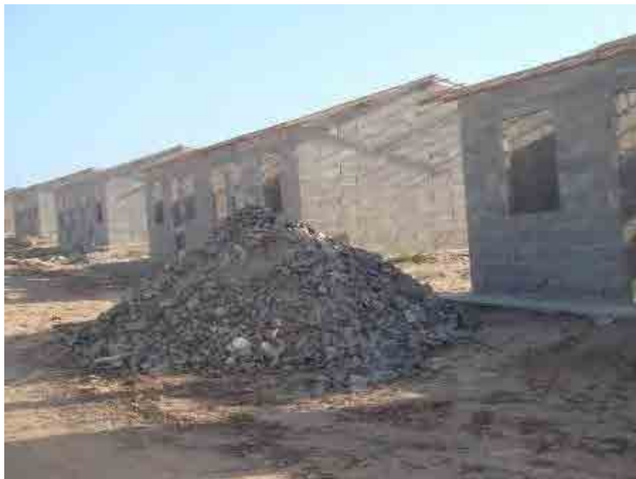
Figura 5 - Entulho em obras de alvenaria estrutural Fonte: Autor
