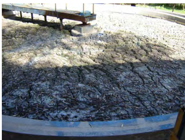
Figura 8. Detalhe do lodo no decantador primário
