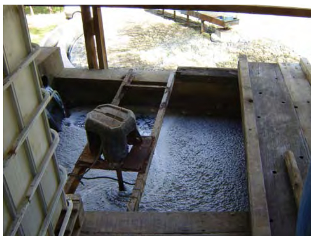
Figura 6. Tanque de acerto de pH, coagulação e floculação
