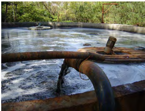
Figura 5. Tanque de recepção de resíduo
