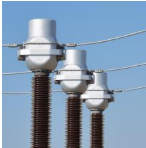
Figura 7. Transformador de Corrente
