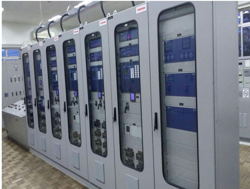
Figura 9. Painel de Controle e Proteção
