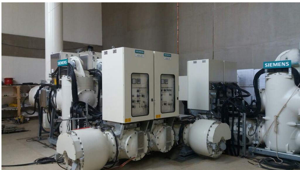
Figura 10. Subestação GIS - Metrô de SP
