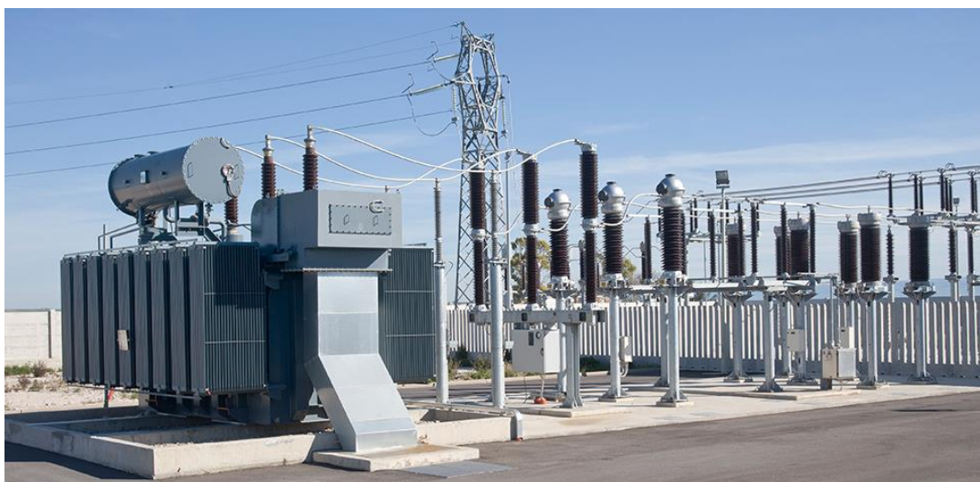
Figura 2. Subestação AIS (Convencional)
