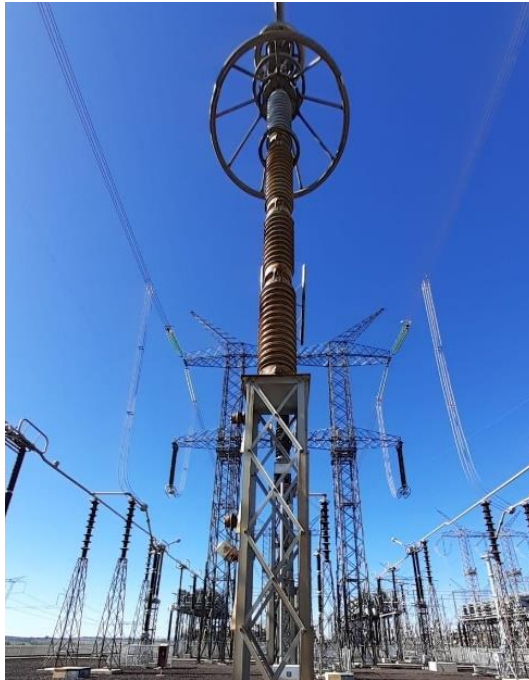
Figura 6. Para-raios em uma subestação de alta tensão
