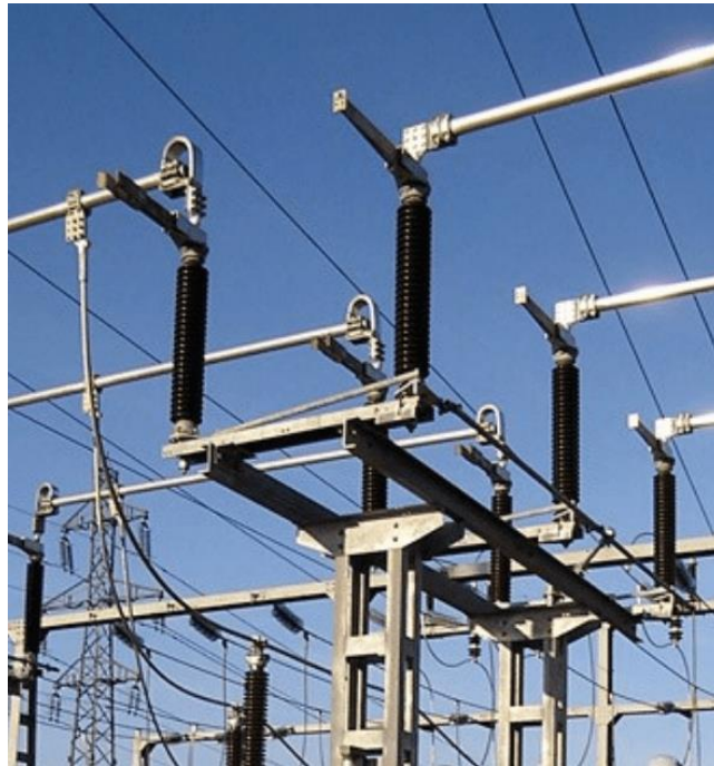
Figura 5. Chave Seccionadora de Alta Tensão
