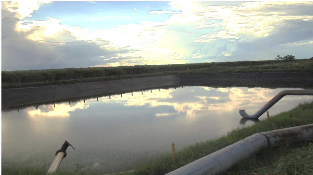
Figura 33 - Tanque reservatório de vinhaça dentro do parque industrial.
