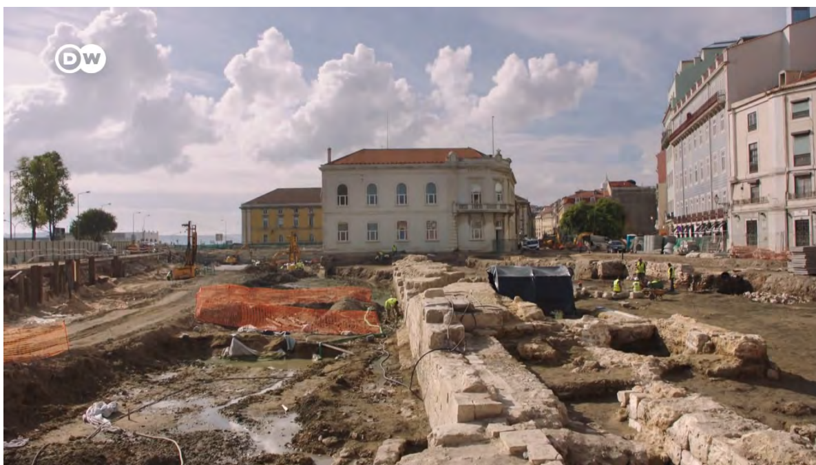
Figura 20 - Escavações do Campo das cebolas, em Alfama - Lisboa, (2018) Fonte: Frame do filme Rotas da escravidão (2018)
