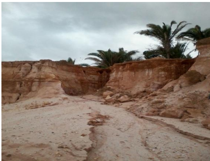
Fotografia 13– Indução ao processo erosivo
