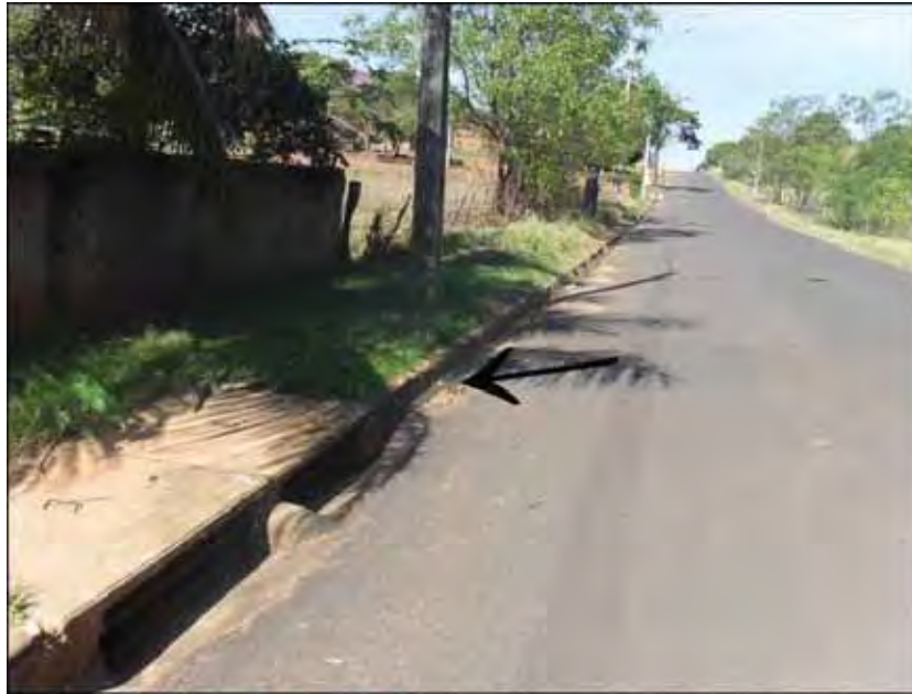
Figura 24 – Boca de lobo, coletora de águas pluviais, em destaque para a guia que escoar o esgoto doméstico procedente das áreas a montante.
