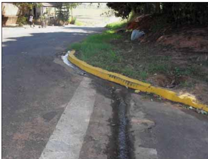
Figura 23 – Escoamento de esgoto doméstico do topo suavemente ondulado das colinas para as vertentes em área impermeabilizada.
