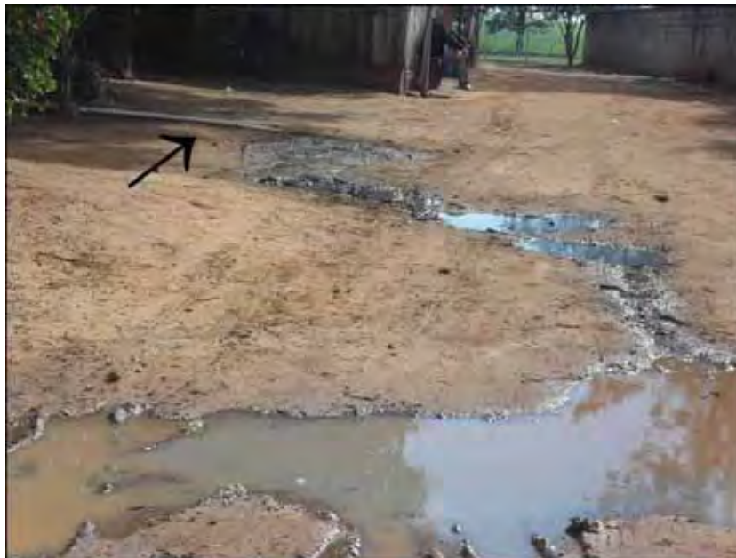
Figura 16 – Despejo de esgoto doméstico, em destaque para o cano de PVC despejando esgoto diretamente em via pública.
