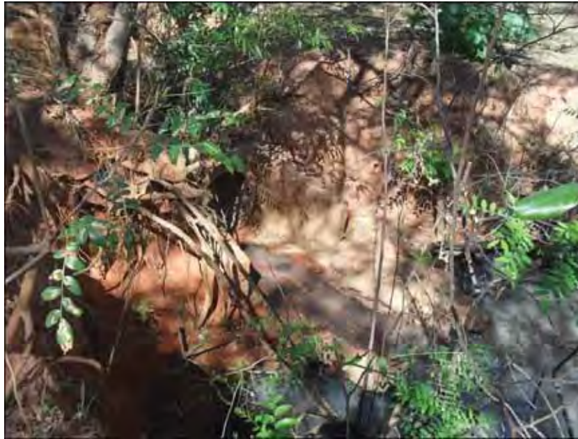
Figura 26 – Tubo de concreto armado que coleta o esgoto doméstico com o lançamento direto no solo sem tratamento. Fonte: Do autor, 2011.
