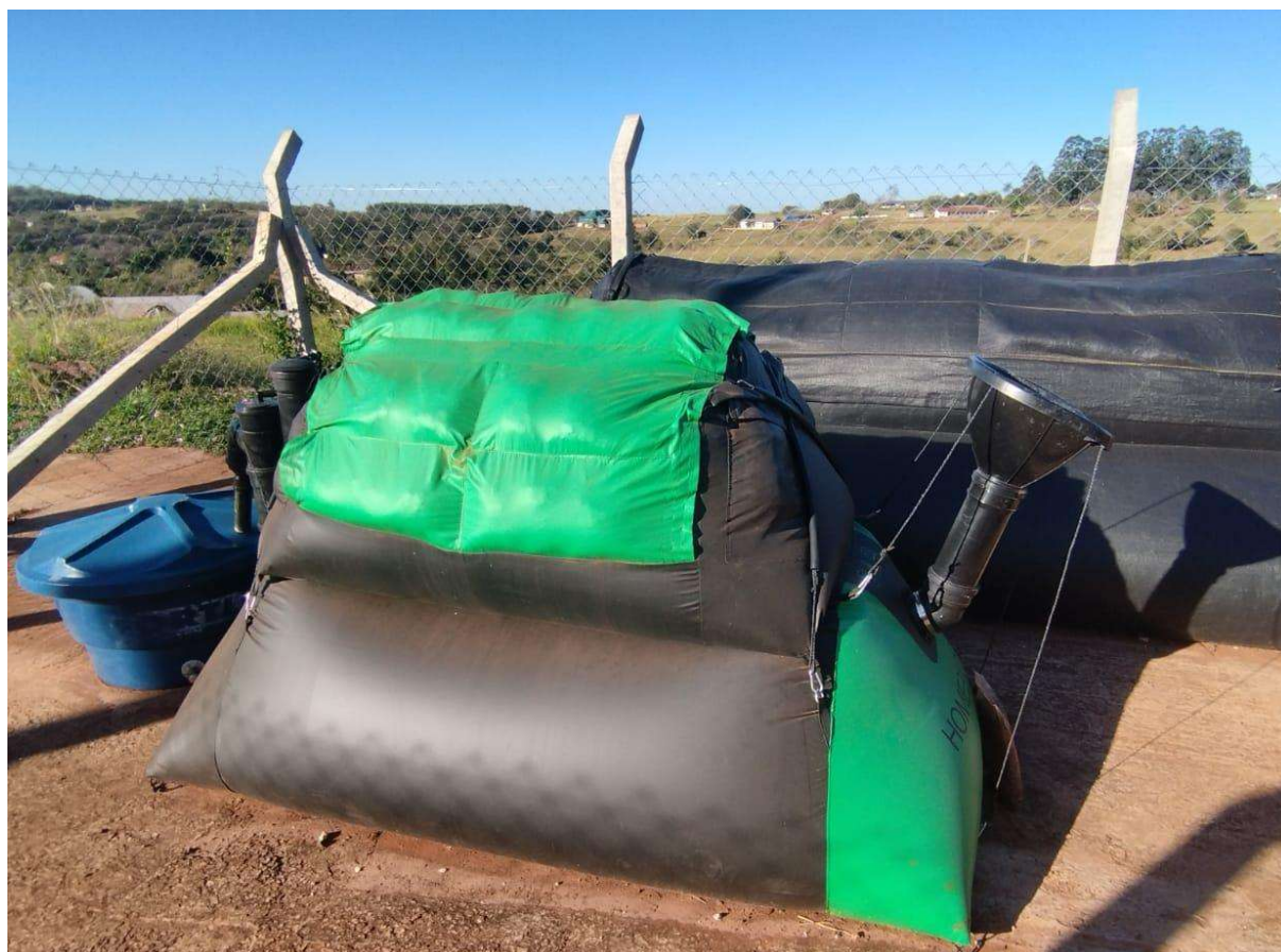
Figura 9 - Biodigestores HomeBiogas™ instalados
