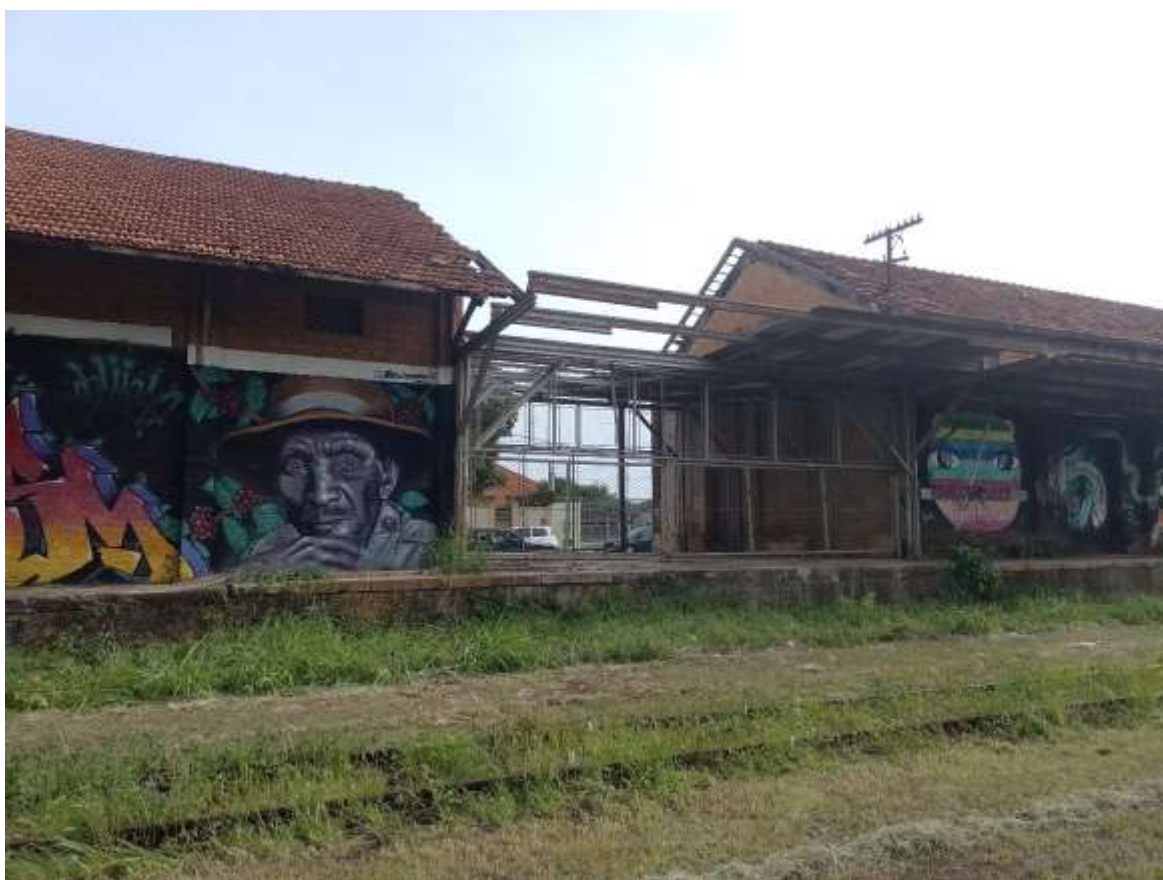
Figura 31: Galpões com danificações na cobertura
