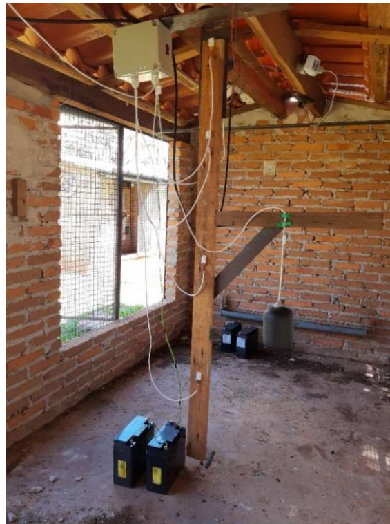
FIGURA 22. INSTALAÇÃO DOS SENSORES DENTRO DO GALPÃO COM TELHA CERÂMICA
