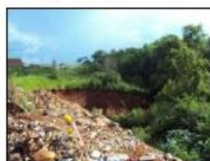
Figura 19: Lixos entulhados as margens do canal. Ao fundo, a presença de grandes erosões.
