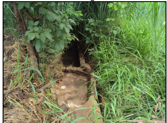
Figura 5.18 - Canais do sistema de drenagem ligados a um dos afluentes do córrego
