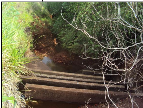
Figura 5.28 - Obras de engenharia para diminuição de velocidade do sistema de drenagem. Abaixo, processo erosivo
