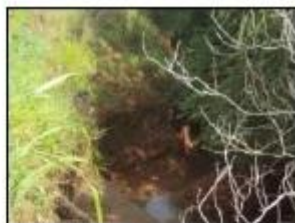
Figura 12: Erosão na saída da canalização.
