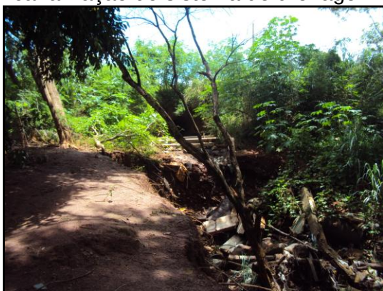
Figura 5.26 - Processo erosivo após canalização do sistema de drenagem
