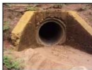
Figura 11: Presença de sedimentos ao final do percurso do canal. Saída da canalização para a rodovia.
